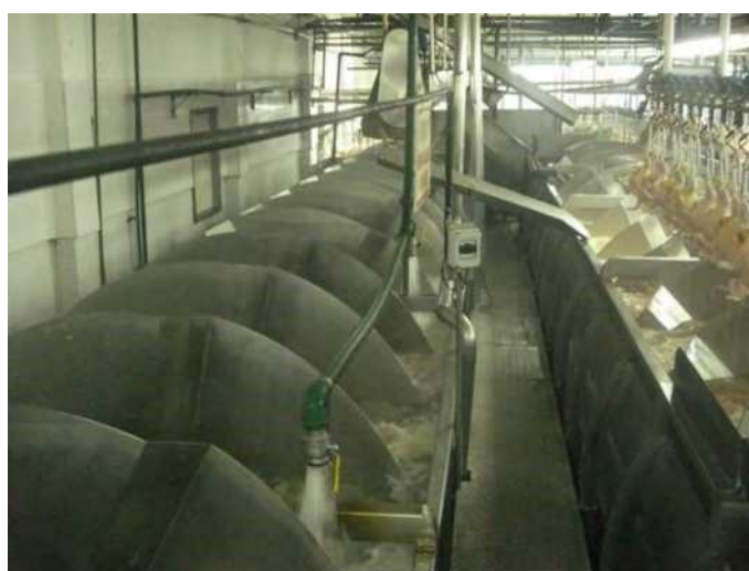
Ilustración 13 Área De Chillers
