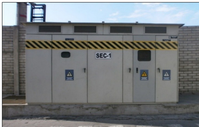
Figura N° 14. Sub estación 400 KVA
