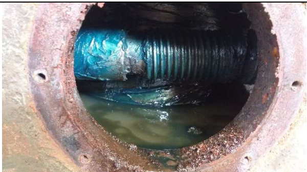
Vista del gusano, en el interior de la carcasa estaba llena de refrigerante que ingreso debido al deterioro de los alojamientos de los cilindros
