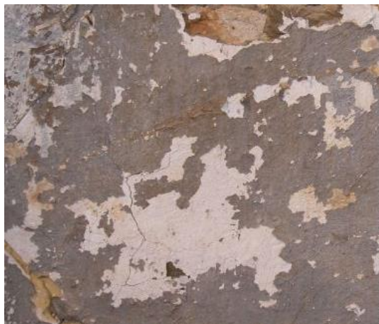
Figura N° 02. Eflorescencia en mortero para enlucido
