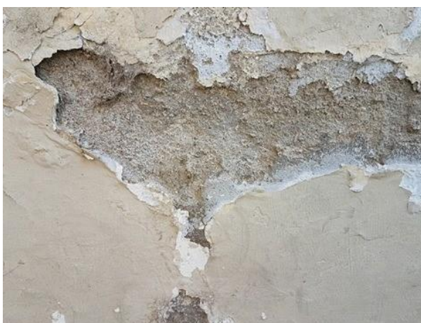
Figura N° 01. Desprendimiento en mortero para enlucido
