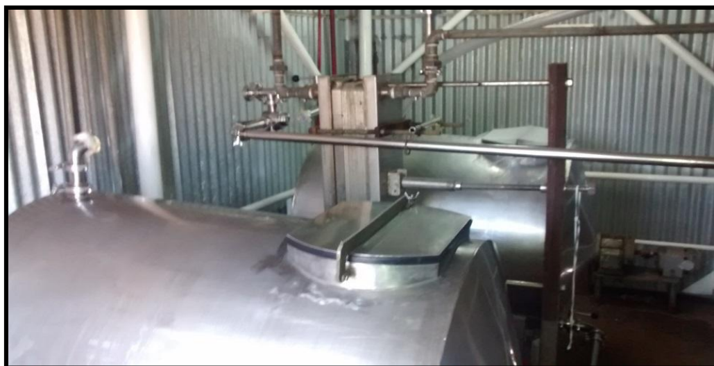
Fig. N° 21: Sistema de Enfriamiento.
