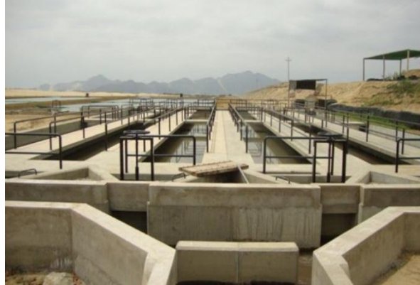
Imagen N° 3: ingreso de desarenadores
