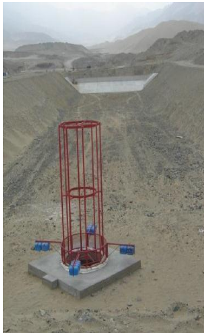
Imagen N° 1: Toma flotante en reservorio
