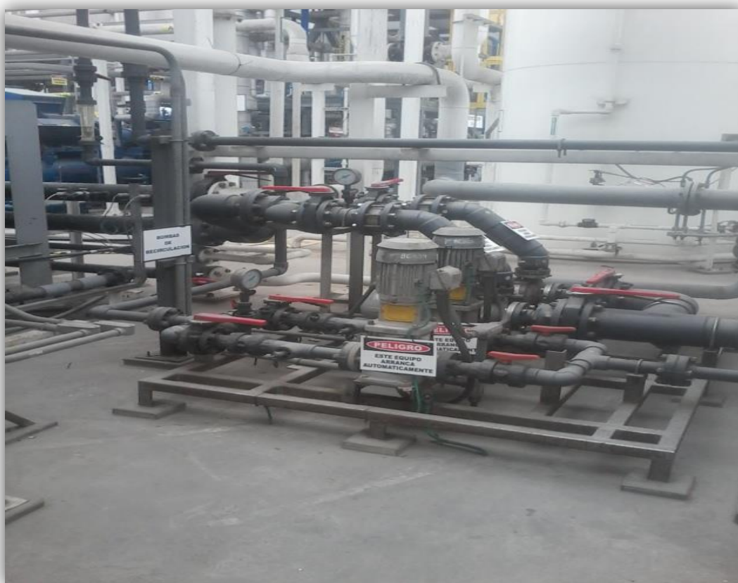
Figura 1. Bomba de retro lavado y compensación.
