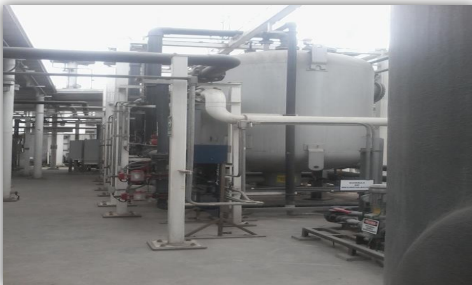
Figura 4. Tanques de filtración.
