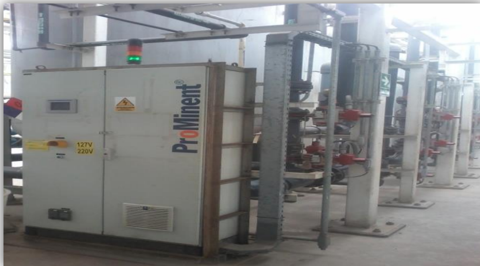
Figura 3. Tablero de control de sistema de filtración.
