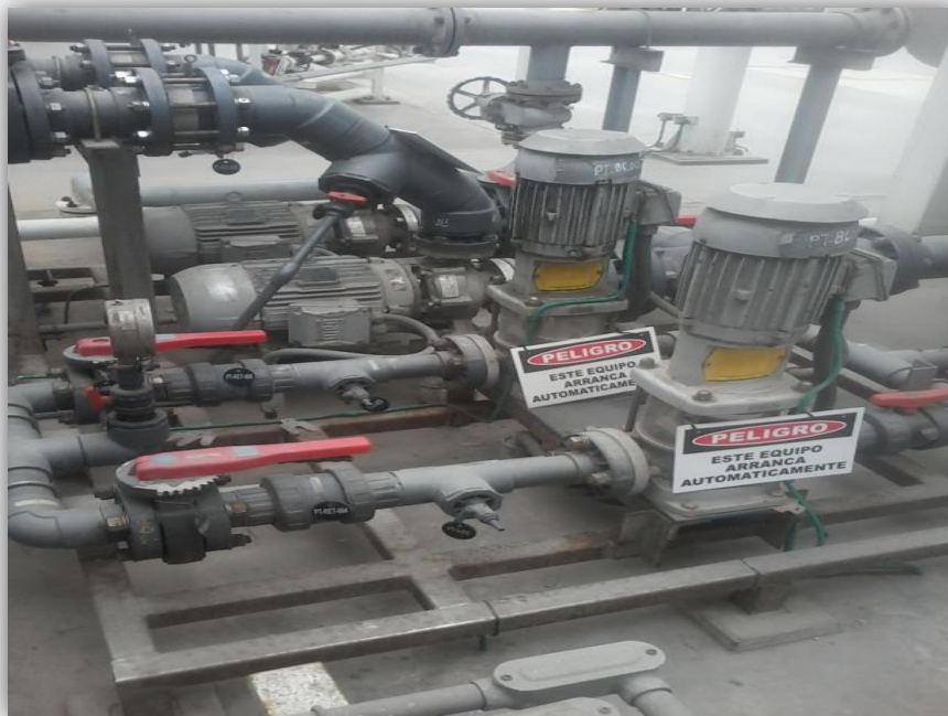
Figura 6. Bomba de retro lavado y compensación
