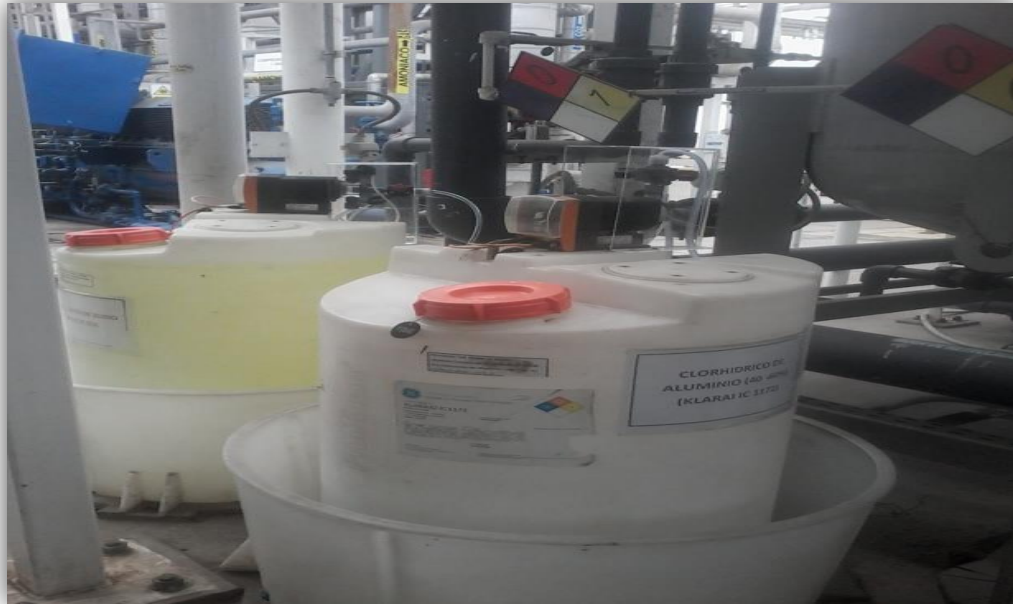
Figura 18. Bombas de Dosificación de Productos Químicos.
