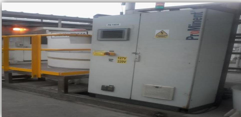
Figura 7. Tablero de control de Osmosis N° 1.
