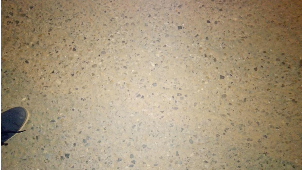
UM - 01. Meteorización / Desprendimiento de Agregados (Nivel de Severidad: Bajo “L”, Medio “M”, Alto “H”)
