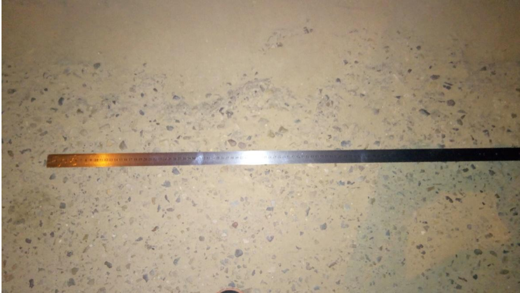
UM - 01. Meteorización / Desprendimiento de Agregados (Nivel de Severidad: Bajo “L”)
