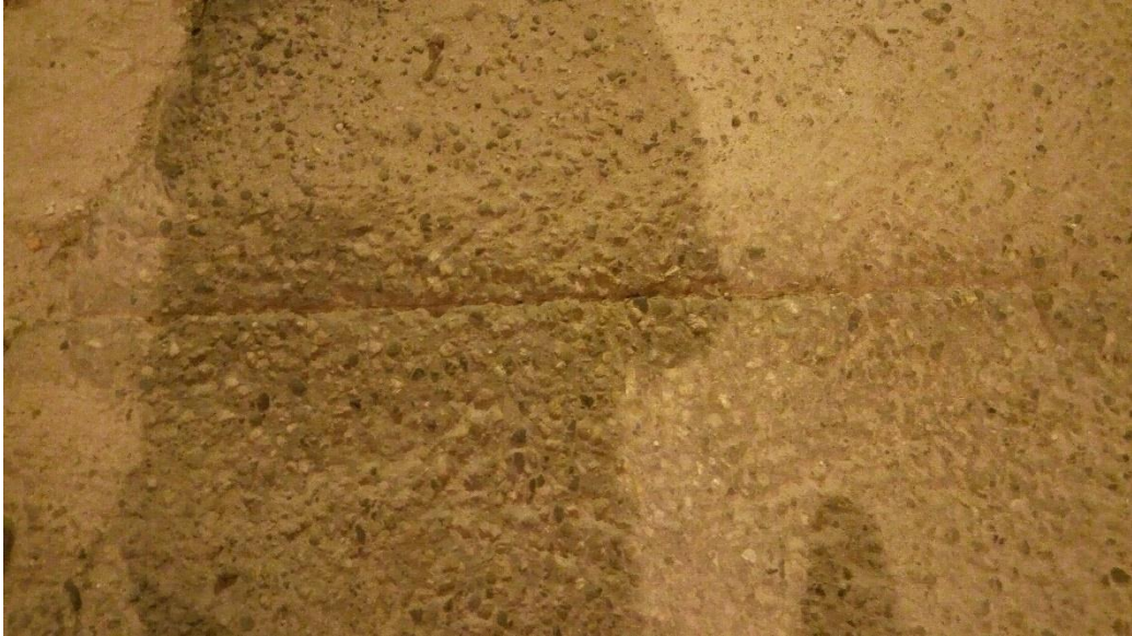
UM - 03. Grieta Longitudinal (Nivel de Severidad: Medio "M")
