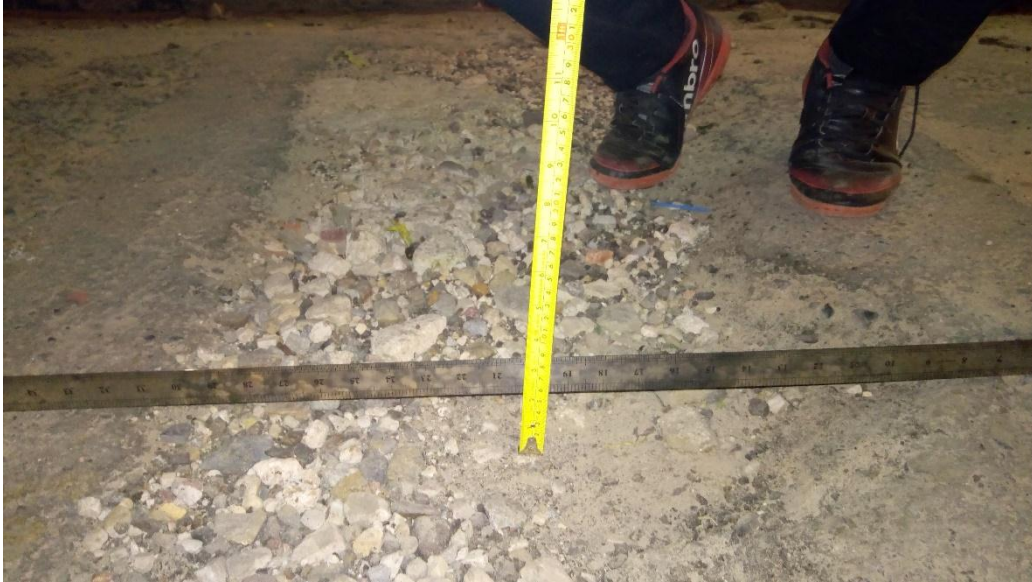
UM - 02. Huecos (Nivel de Severidad: Medio "M")
