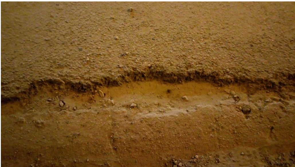
UM - 01. Grieta de Borde (Nivel de Severidad: Medio “M”)
