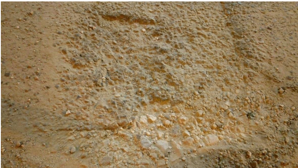
UM - 06. Meteorización / Desprendimiento de Agregados (Nivel de Severidad: Bajo "L", Medio "M")
