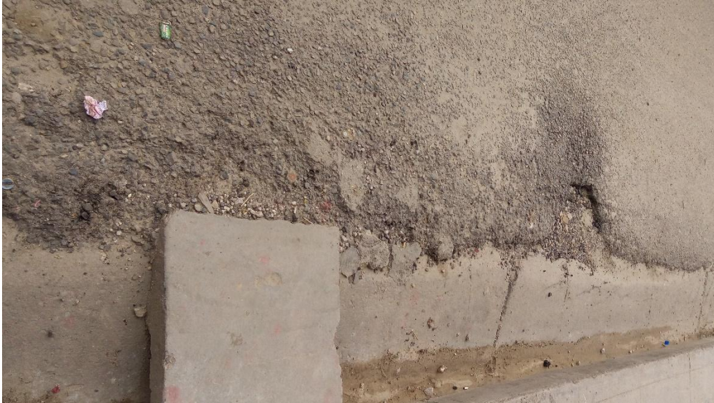
UM - 07. Grieta de Borde (Nivel de Severidad: Bajo “L”)
