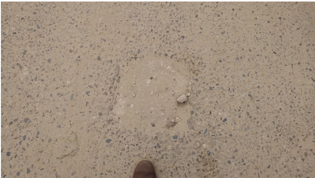
UM - 02. Huecos (Nivel de Severidad: Medio “M”)
