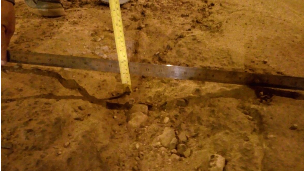
UM - 02. Huecos (Nivel de Severidad: Bajo “L”, Medio “M”)
