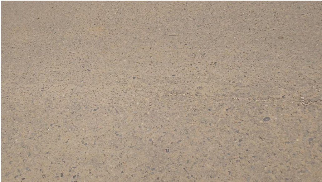
01. Grieta Longitudinal (Nivel de Severidad: Bajo "L")
