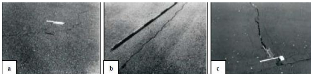
Figura N° 11: Grietas longitudinales y transversales. bajo (a), Medio (b) y Alto (c).
