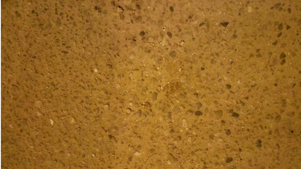
UM - 04. Meteorización / Desprendimiento de Agregados (Nivel de Severidad: Bajo “L”, Medio “M”, Alto “H”)
