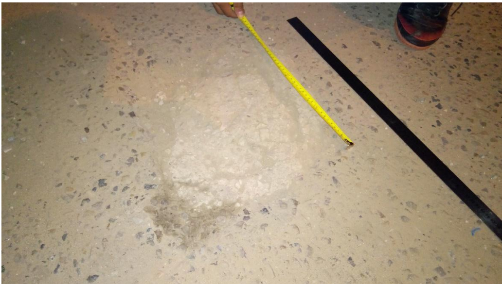
UM - 04. Parcheo Acometidas De Servicios Públicos (Nivel de Severidad: Medio “M”, Alto “H”)
