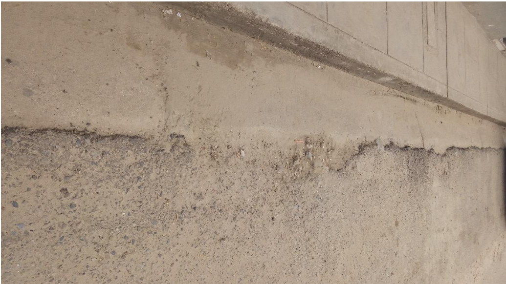
UM - 01. Grieta de Borde (Nivel de Severidad: Bajo “L”, Medio “M”, Alto “H”)
