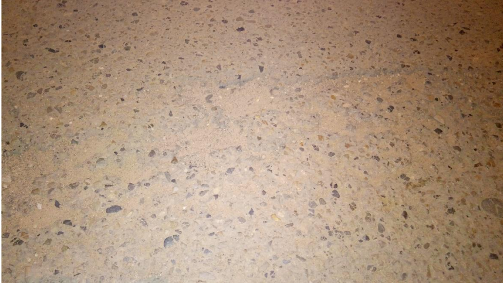
UM - 01. Meteorización / Desprendimiento de Agregados (Nivel de Severidad: Bajo “L”, Medio “M”)
