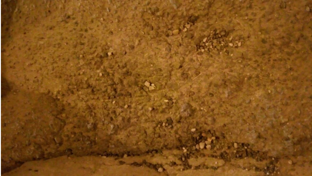
UM - 01. Meteorización / Desprendimiento de Agregados (Nivel de Severidad: Bajo “L”, Medio “M”)
