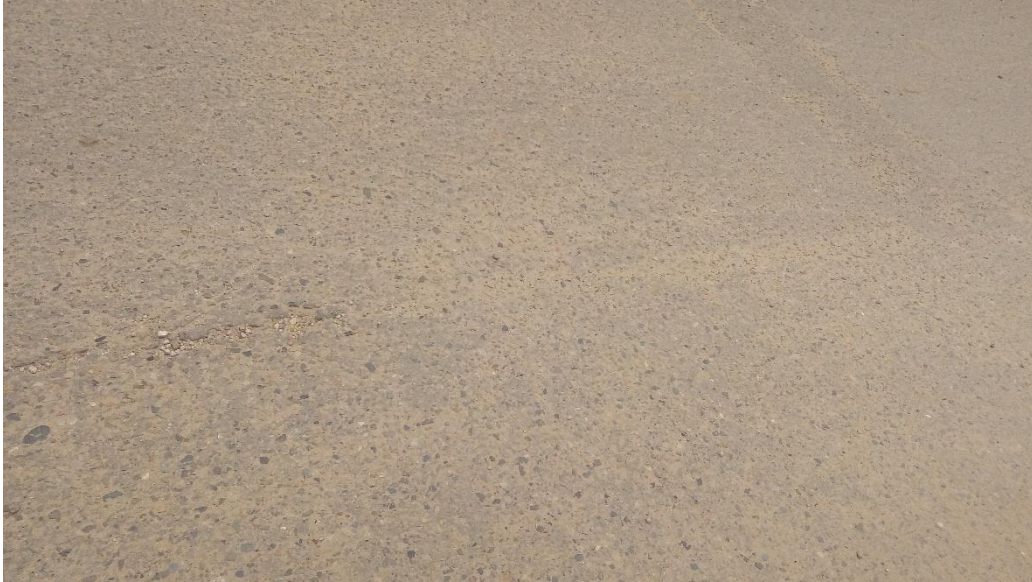
UM - 02. Grieta Longitudinal (Nivel de Severidad: Medio “M”)
