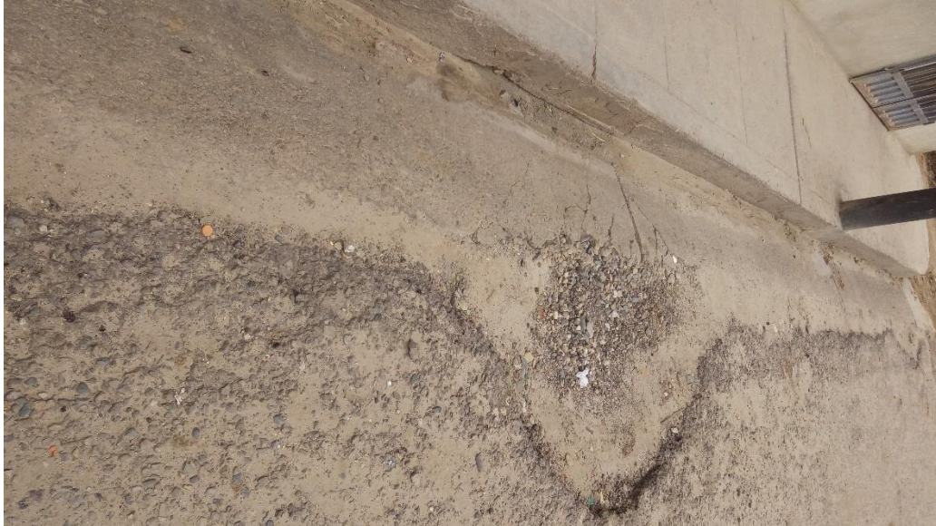
UM - 02. Grieta de Borde (Nivel de Severidad: Medio “M”, Alto “H”)
