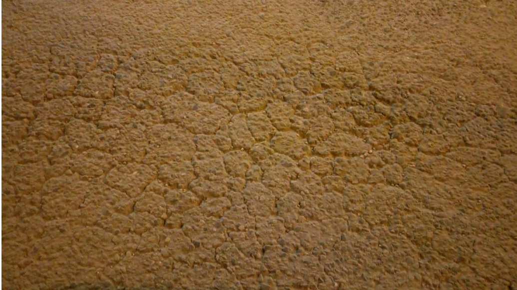
UM - 04. Piel de Cocodrilo (Nivel de Severidad: Bajo “L”)
