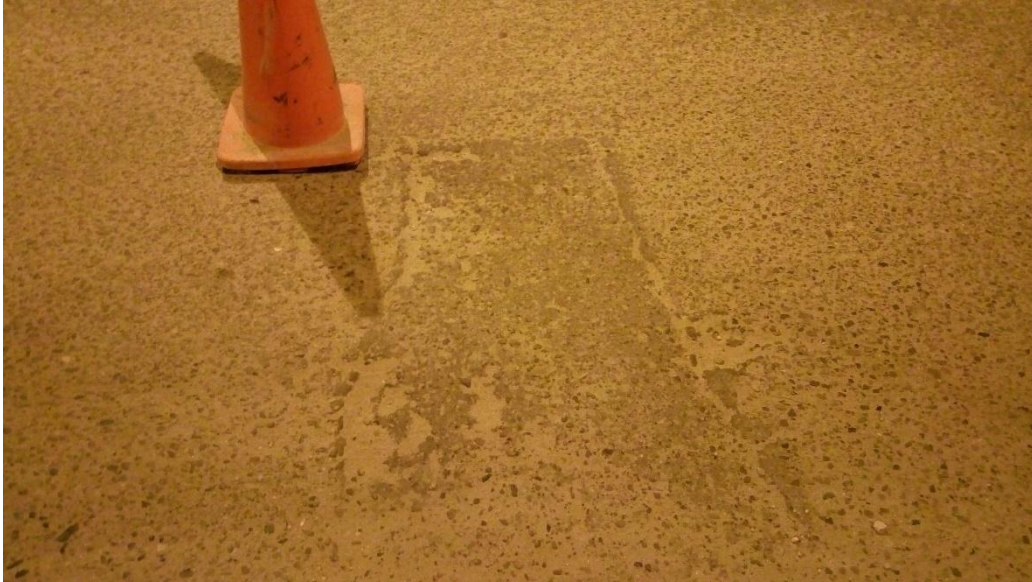
UM - 02. Parcheo Acometidas De Servicios Públicos (Nivel de Severidad: Bajo “L”, Alto “H”)
