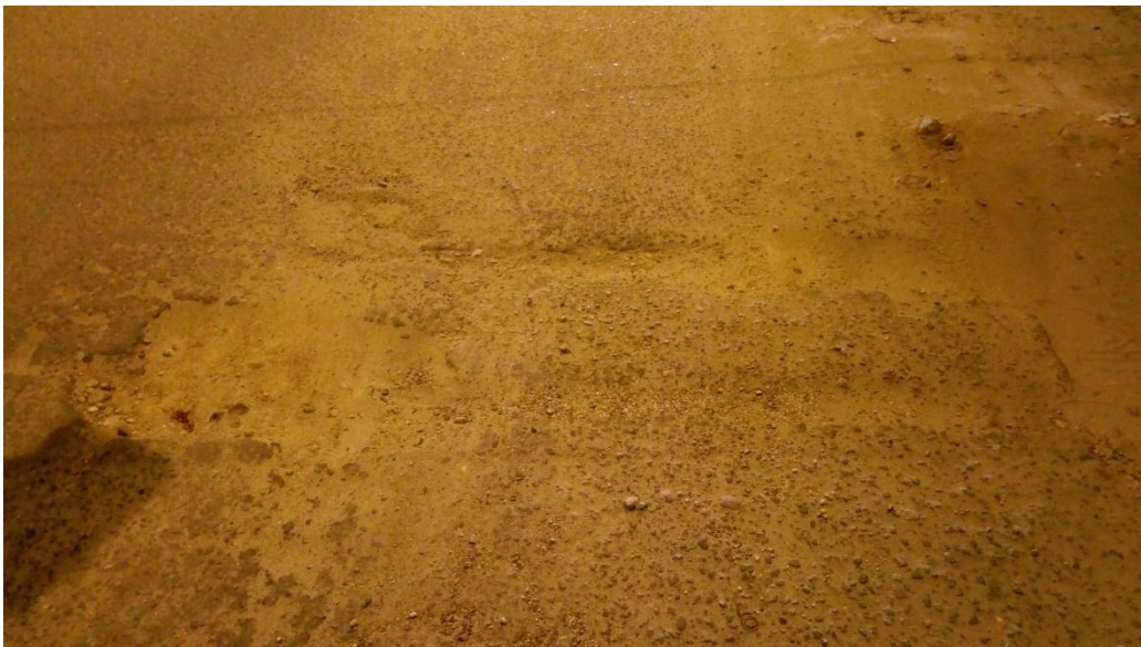
UM - 01. Parcheo Acometidas De Servicios Públicos (Nivel de Severidad: Bajo “L”, Medio “M”)
