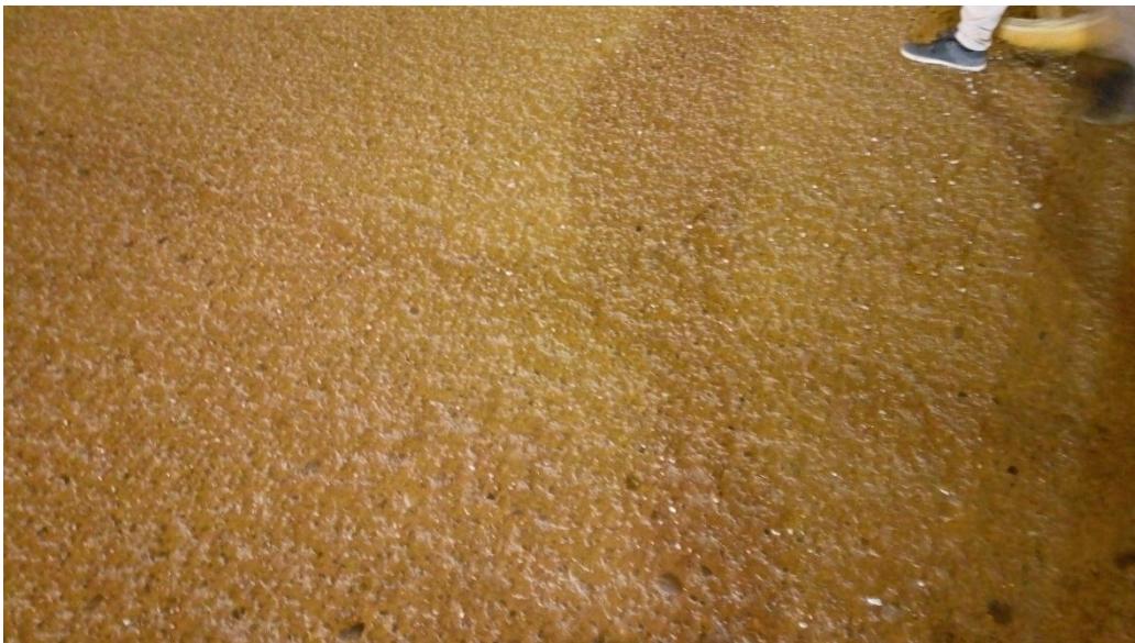
UM - 03. Meteorización / Desprendimiento de Agregados (Nivel de Severidad: Bajo “L”, Medio “M”)
