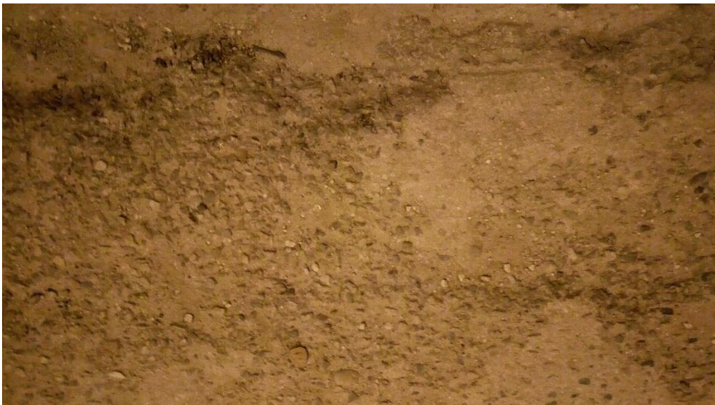
UM - 08. Meteorización / Desprendimiento de Agregados (Nivel de Severidad: Medio "M")
