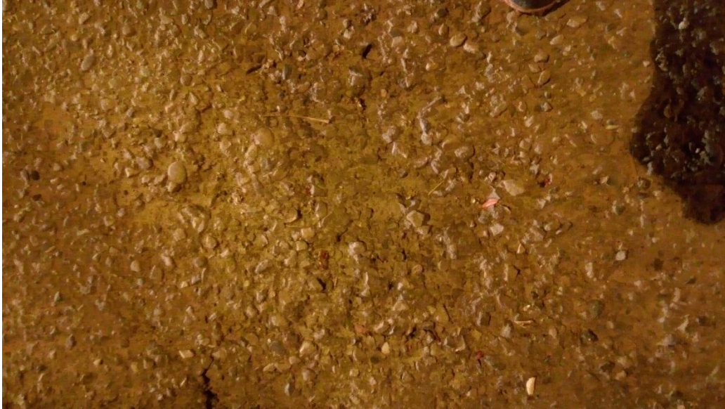
UM - 01. Meteorización / Desprendimiento de Agregados (Nivel de Severidad: Medio “M”)
