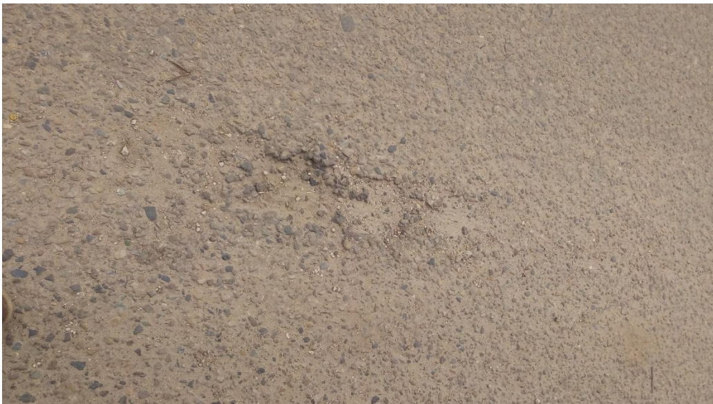
UM - 02. Huecos (Nivel de Severidad: Medio "M")
