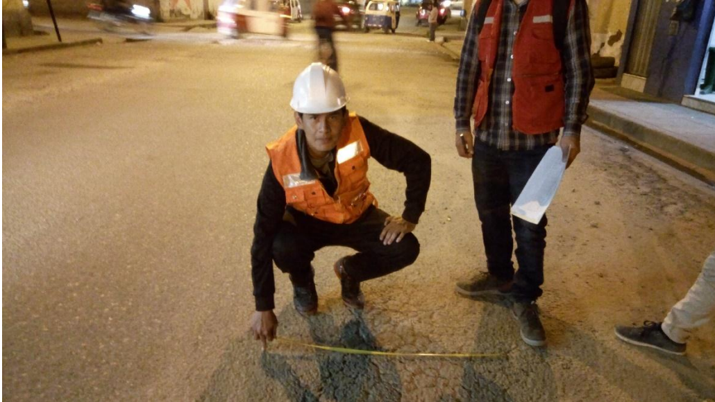
UM - 01. Piel de Cocodrilo (Nivel de Severidad: Medio “M”)
