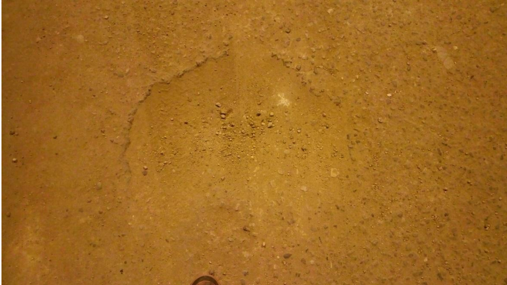
UM - 06. Huecos (Nivel de Severidad: Medio "M")
