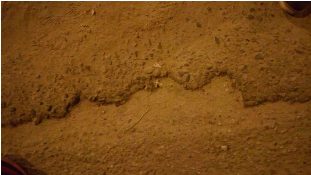
UM - 03. Grieta de Borde (Nivel de Severidad: Bajo “L”, Medio “M”, Alto “H”)
