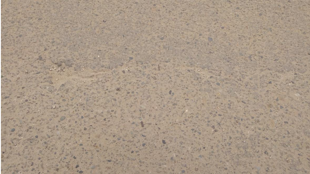
UM - 02. Grieta Longitudinal (Nivel de Severidad: Medio “M”)
