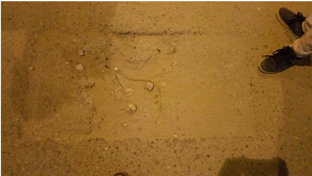
UM - 05. Parcheo Acometidas De Servicios Públicos (Nivel de Severidad: Medio “M”, Alto “H”)
