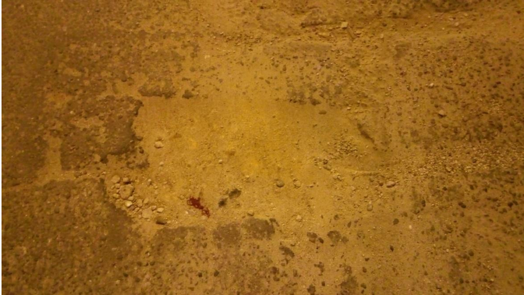
UM - 03. Huecos (Nivel de Severidad: Bajo “L”, Medio “M”)
