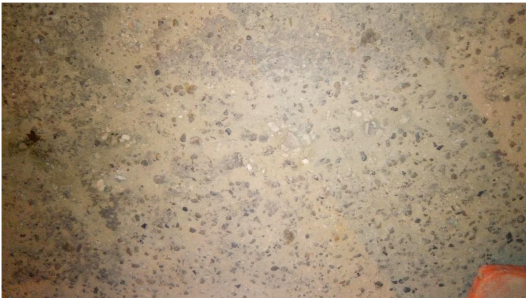
UM - 07. Meteorización / Desprendimiento de Agregados (Nivel de Severidad: Bajo "L", Medio "M")
