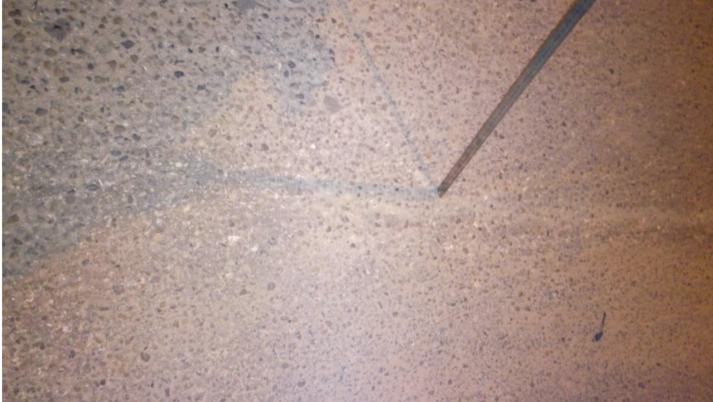
UM - 04. Grieta Longitudinal (Nivel de Severidad: Medio “M”)
