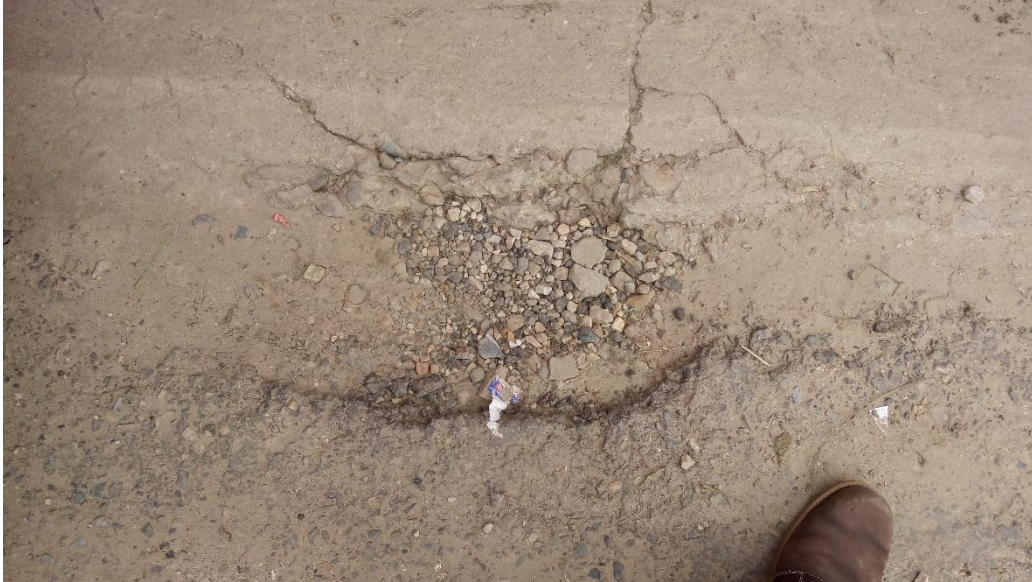
UM - 02. Grieta de Borde (Nivel de Severidad: Bajo “L”, Medio “M”, Alto “H”)
