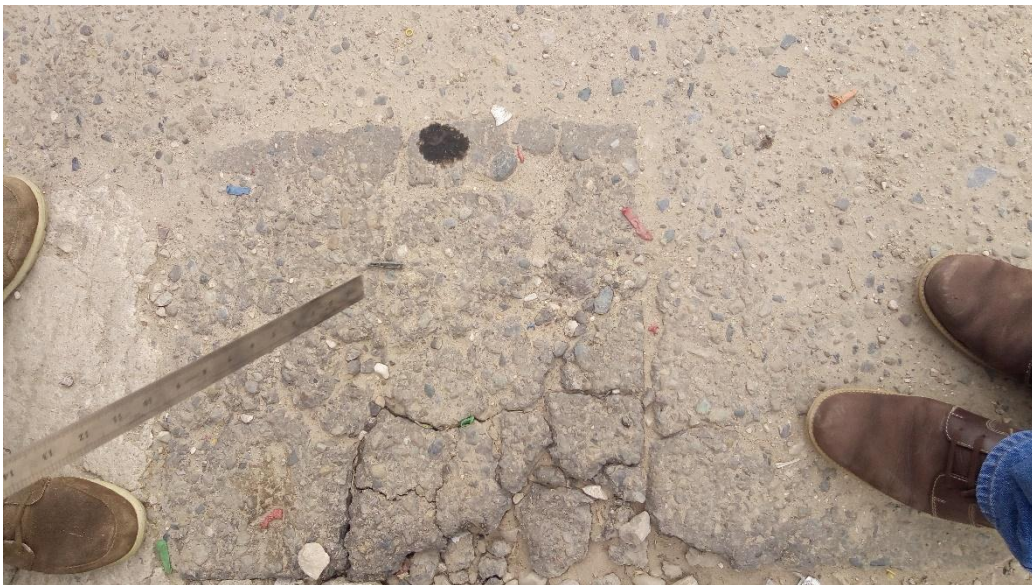
UM - 01. Parcheo Acometidas De Servicios Públicos (Nivel de Severidad: Bajo “L”, Medio “M”, Alto “H”)
