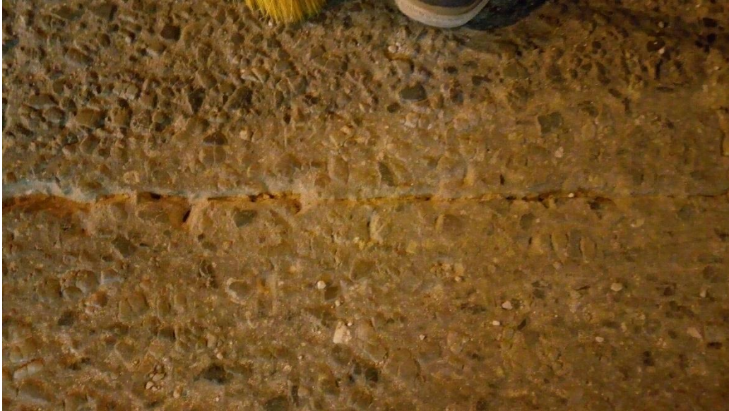
UM - 01. Grieta Longitudinal (Nivel de Severidad: Bajo: “L”, Medio “M”)
