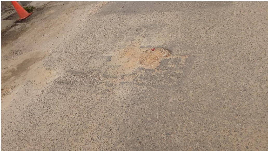
UM - 01. Parqueo Acometidas De Servicios Públicos (Nivel de Severidad: Bajo “L”, Medio “M”, Alto “H”)
