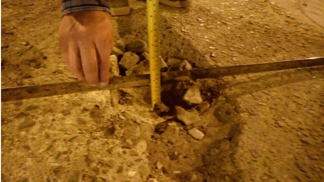
UM - 08. Huecos (Nivel de Severidad: Medio "M")
