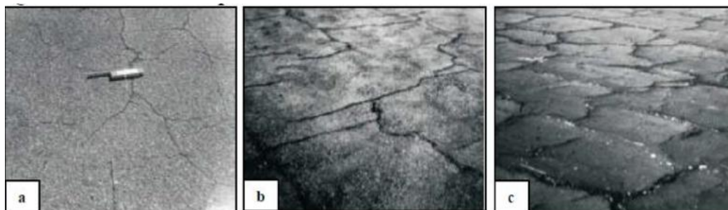
Figura N° 4: Agrietamiento en bloque. Bajo (a), Medio (b), Alto (c).
