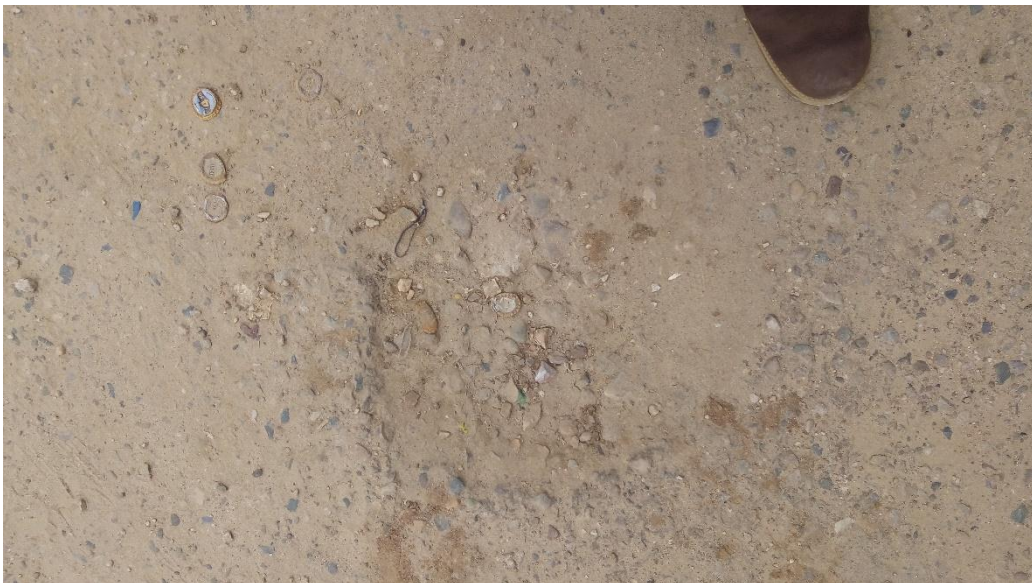
UM - 02. Huecos (Nivel de Severidad: Bajo “L”, Medio “M”)
