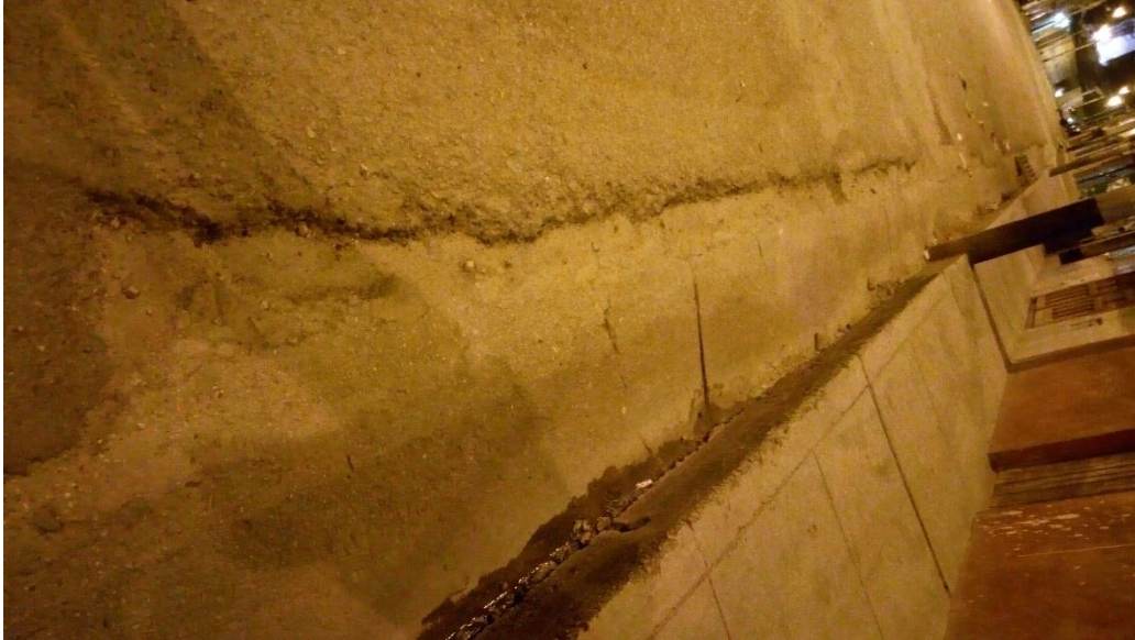
UM - 08. Grieta de Borde (Nivel de Severidad: Bajo “L”)
