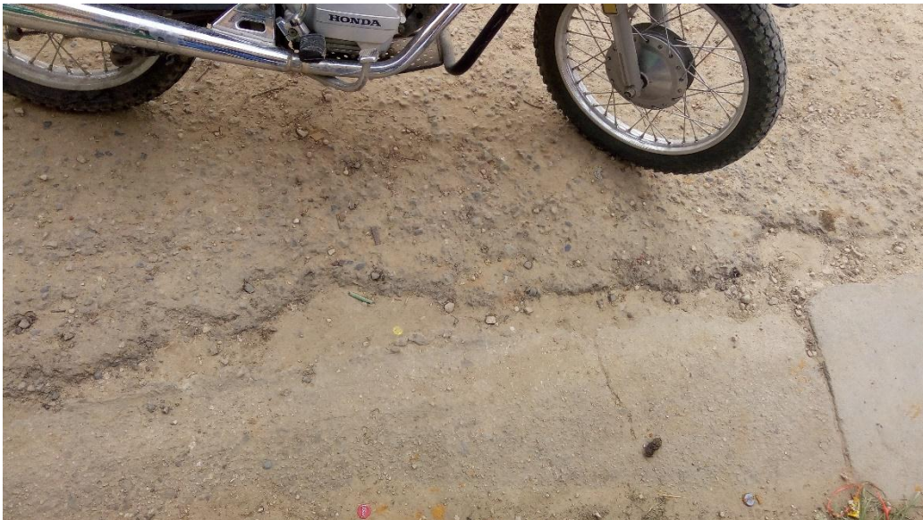
UM - 02. Grieta de Borde (Nivel de Severidad: Medio “M”, Alto “H”)
