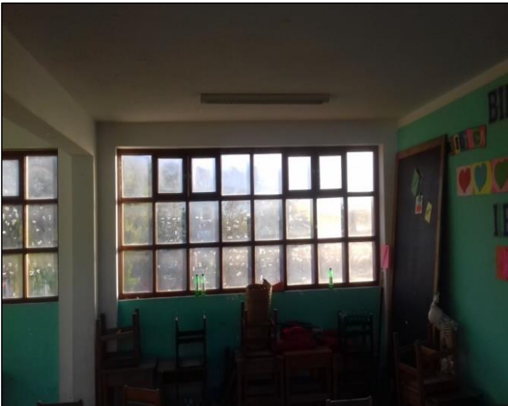
FOTO N° 12: Columna T en aulas presentes en el módulo “A”.
