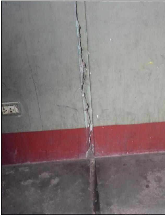
FOTO N° 9: Fisura entre juntas en paredes de la I.E
