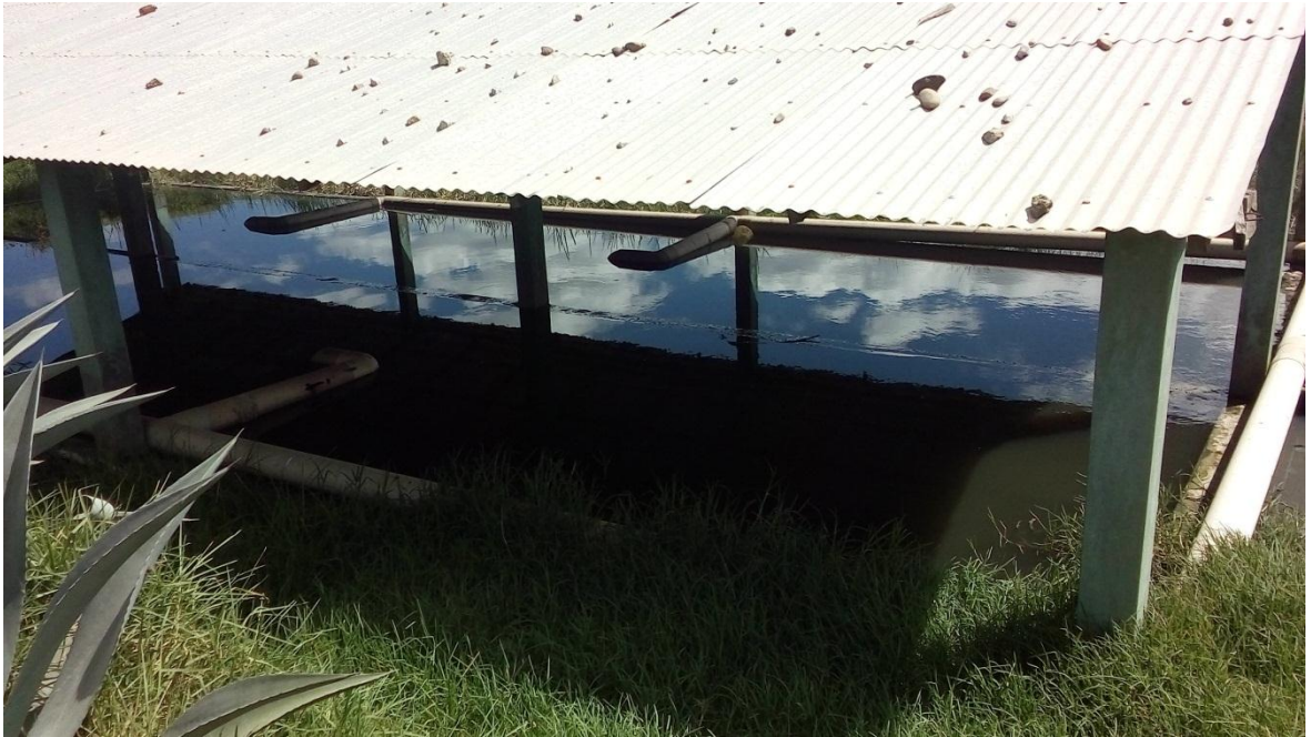
FOTOGRAFÍA N° 19: Lecho de secado
