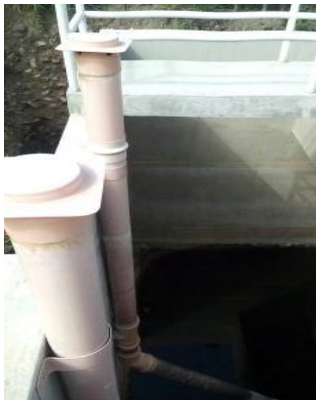
FOTOGRAFÍA N° 46: Tubería De Ventilación
