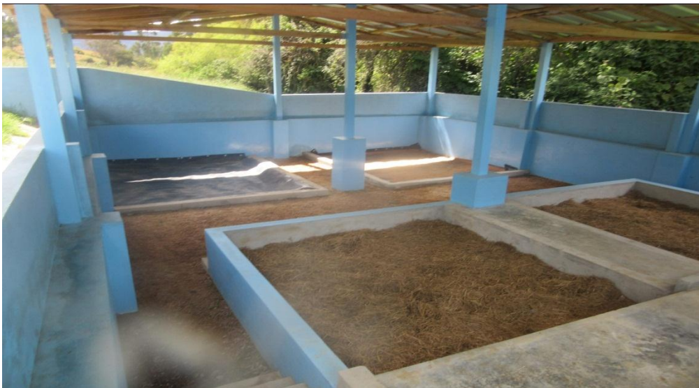
FOTOGRAFÍA N° 16: Lecho de secado de lodos
