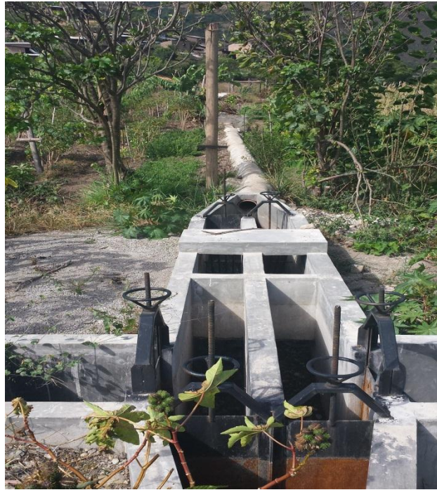
FOTOGRAFÍA N° 51: Ingreso De Aguas Residuales
