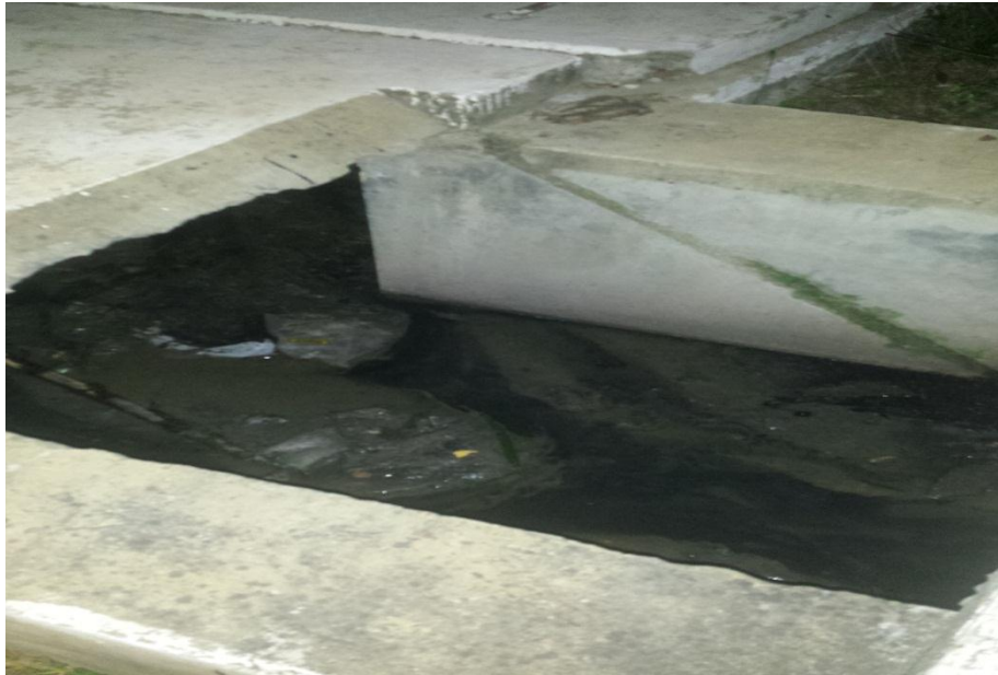
FOTOGRAFÍA N° 21: Entrada de aguas residuales
