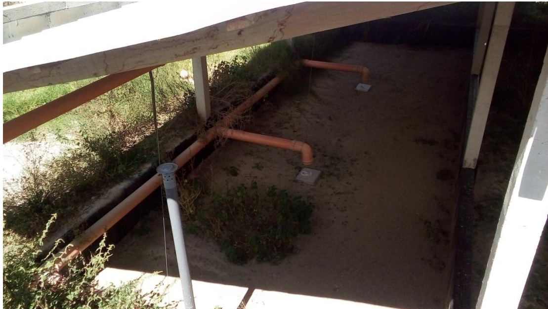
FOTOGRAFÍA N° 77: Lecho De Secado
