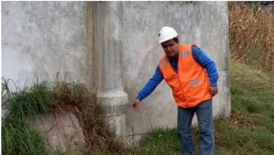
FOTOGRAFÍA N° 60: falla de estructura
