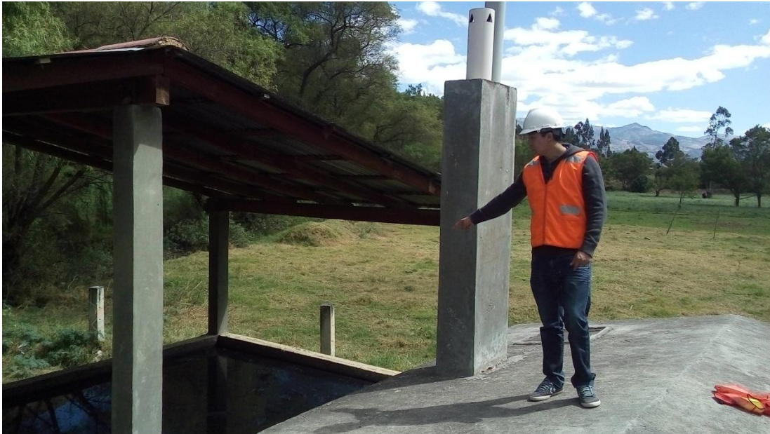
FOTOGRAFÍA N° 81: evaluando el tanque Imhoff
