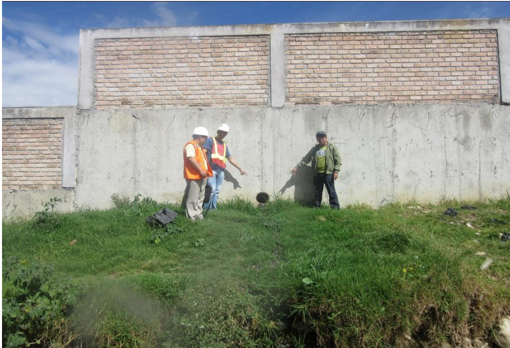
FOTOGRAFÍA N° 30: Tubería de rebose
