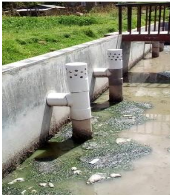
FOTOGRAFÍA N° 68: tubería de remoción
