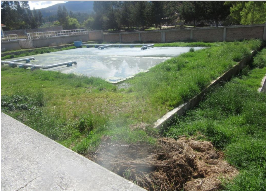
FOTOGRAFÍA N° 28: Lecho de secado
