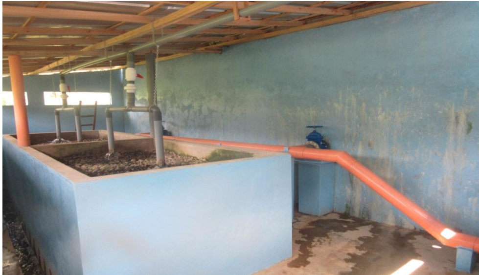
FOTOGRAFÍA N° 15: purificación mediante filtros de agregados
