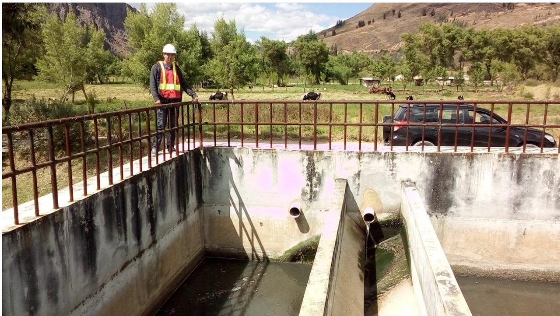
FOTOGRAFÍA N° 22: infiltración de agua en sedimentador
