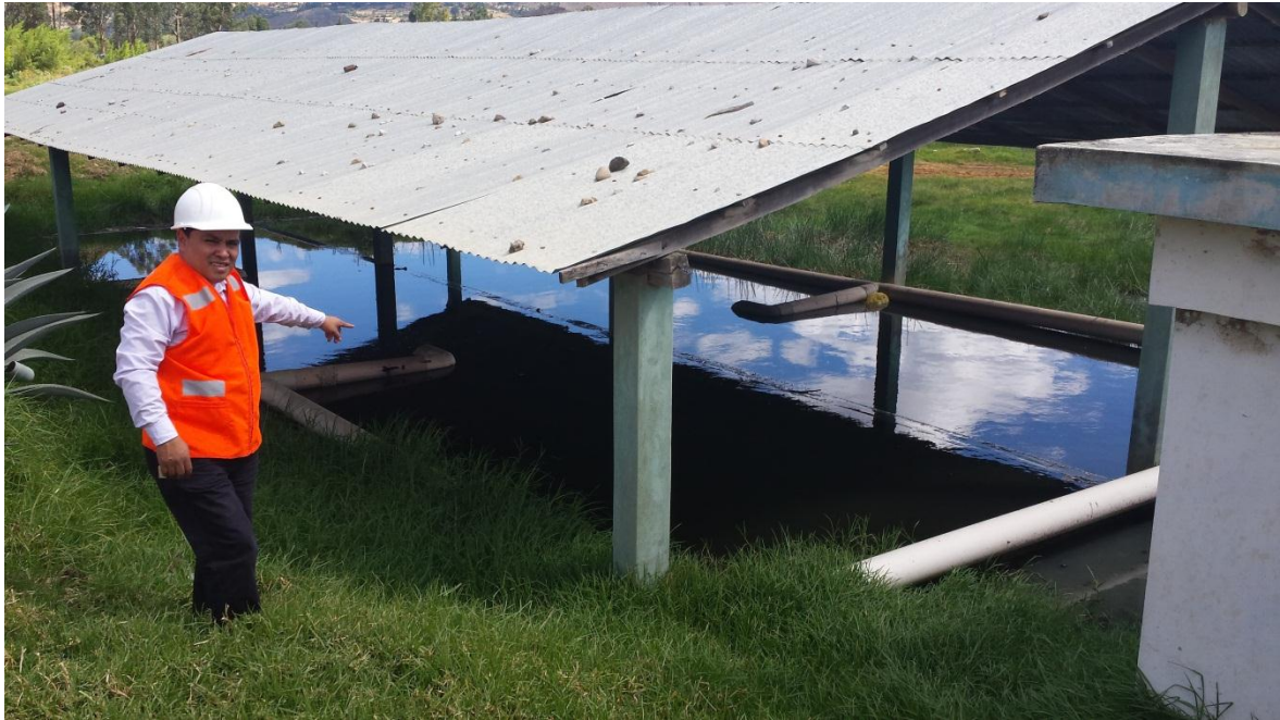
FOTOGRAFÍA N° 23: colapso de tanque Imhoff
