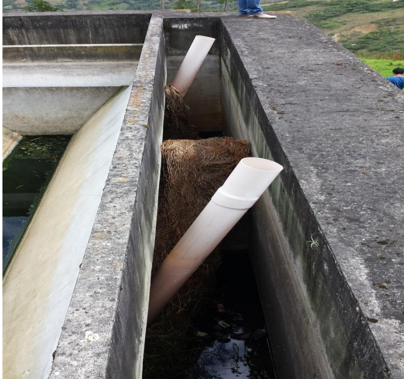
FOTOGRAFÍA N° 59: Cámara De Digestión Y Tubería De Ventilación
