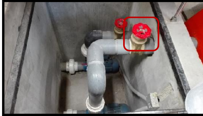
Fotografía 48. Descarga a tanque de alimentación de recirculación
