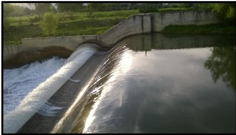
Fotografía 11. Séptimo vertedero – Salto Sky (Mes de Febrero)
