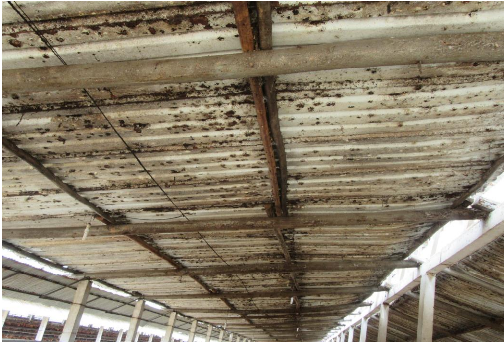
Figura N° 43: Falta de mantenimiento de galpones
