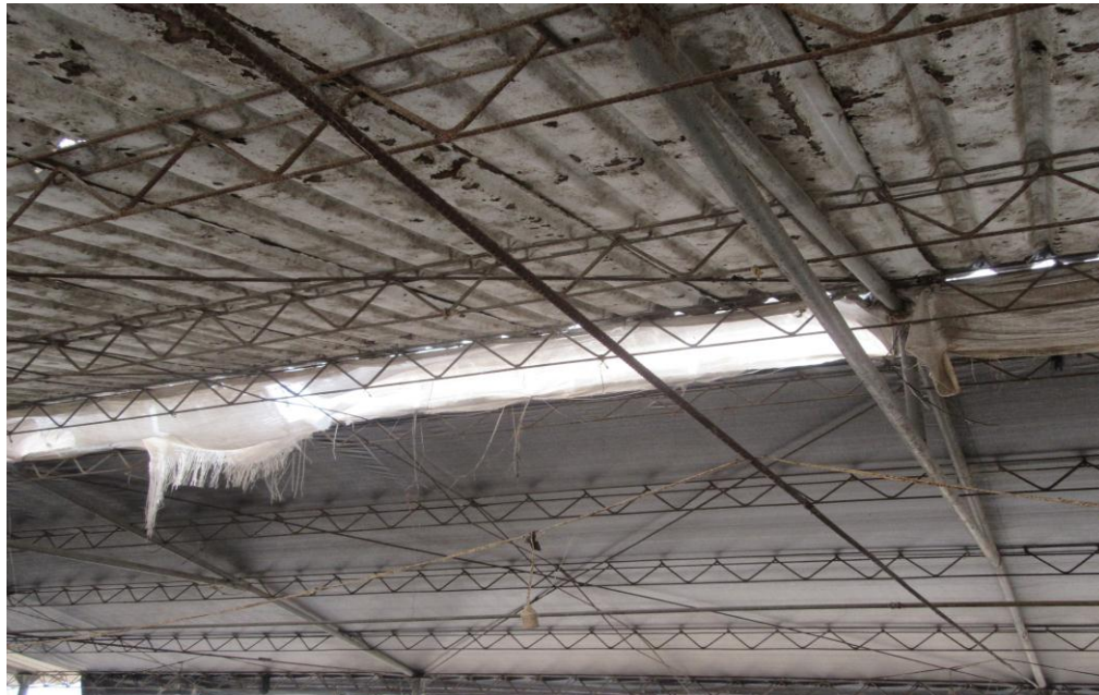
Figura N° 23: Falta mantenimiento de galpones
