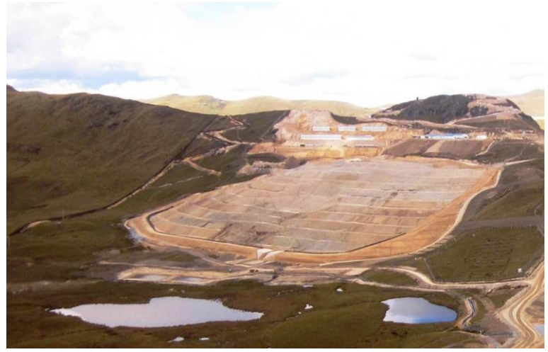
Depósito de Material Inadecuado
