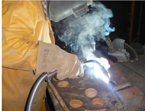
Figura n.º 12: Imagen del proceso de soldadura con alambre tubular de una cantonera Fuente: Esco Perú S.R.L.
