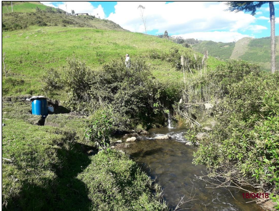
Fotografía N° 29: Culminación de Filtros
