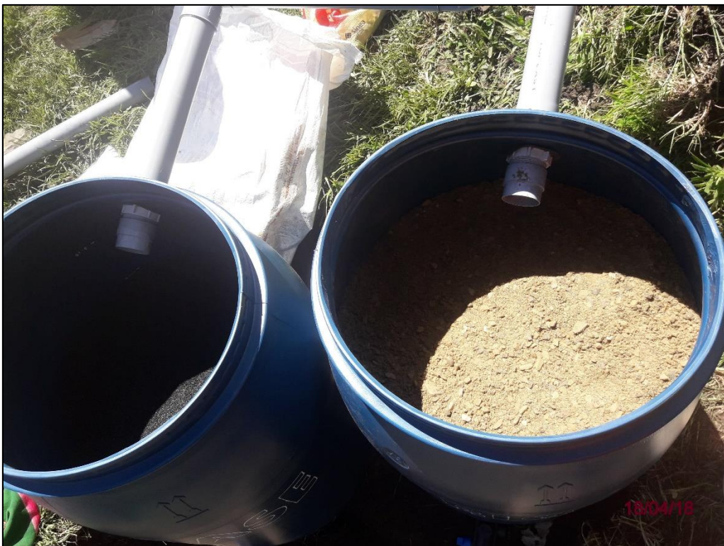
Fotografía N° 23: Filtro A (Capa de carbón activado) - Filtro B (Arena gruesa)
