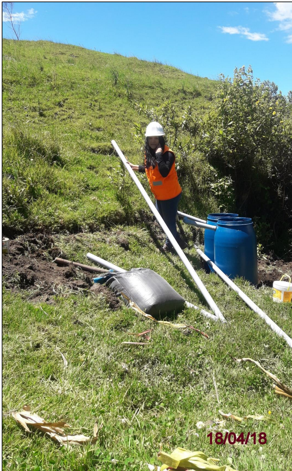
Fotografía N° 9: Ubicación de tubería para alimentación de filtros
