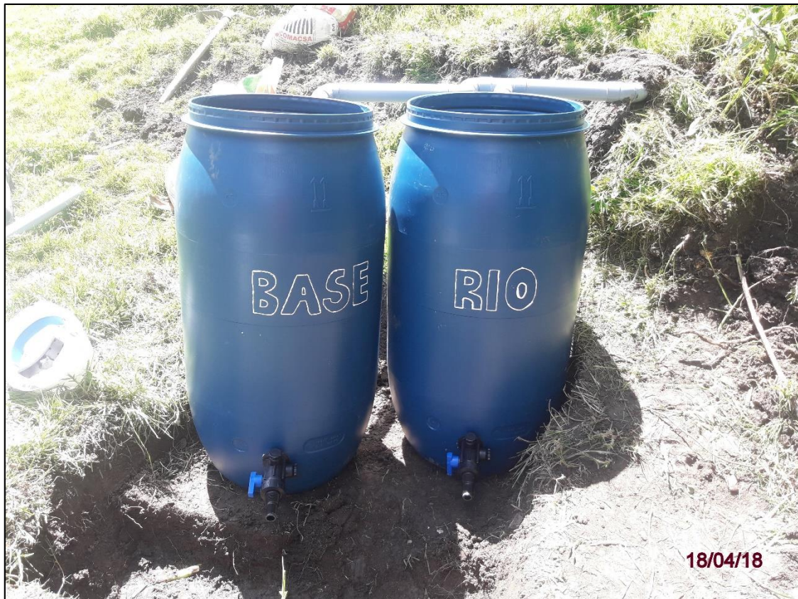
Fotografía N° 13: Ubicación de Filtros ensamblados
