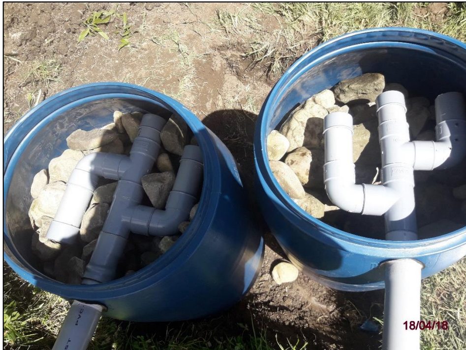
Fotografía N° 25: Alimentación de agua a cada filtro
