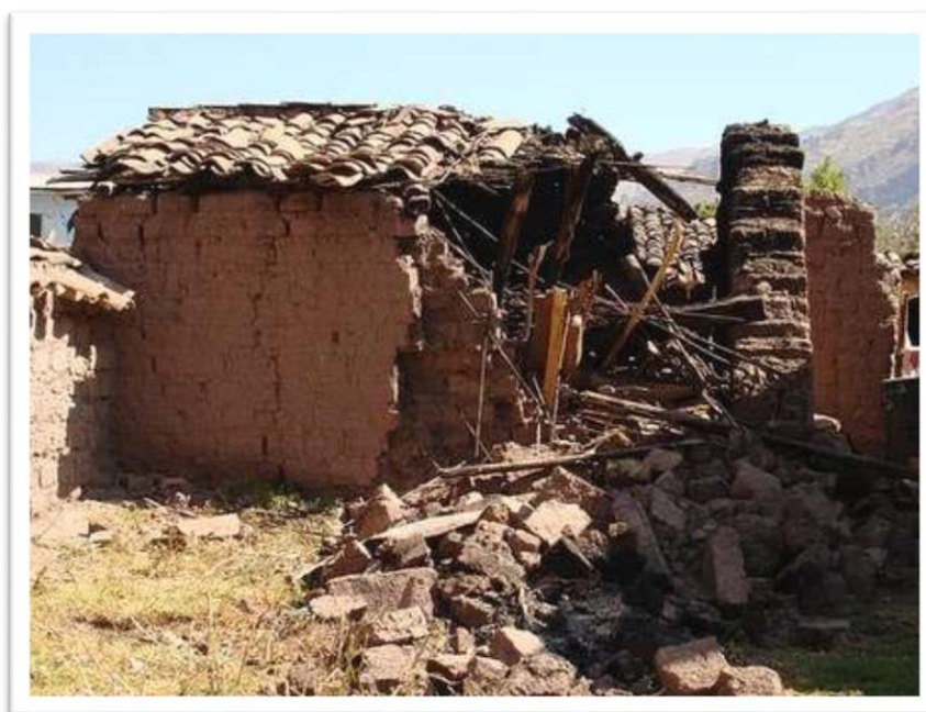
Figura N° 3: Muestra el colapso de viviendas de adobe producidas por el terremoto de Pisco, 15 de agosto del 2007 Perú.
