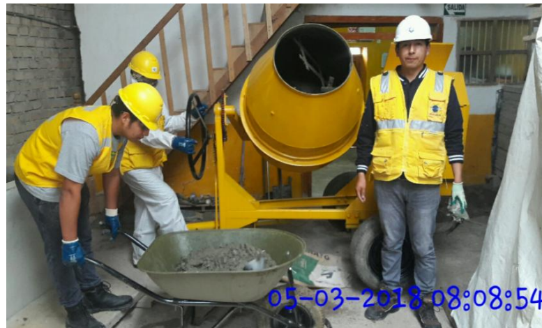
Figura 52 Vista de la mezcla en la Carretilla tipo Buggie listo para el ensayo.
