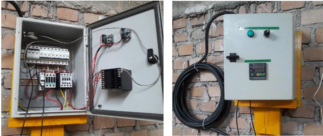
Figura 17 Caja de control vista interior y exterior
