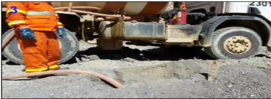
Figura 6. Relleno de agua a los taladros (cisterna) y evidencia que el fluido se disipa por las grietas del terreno.
