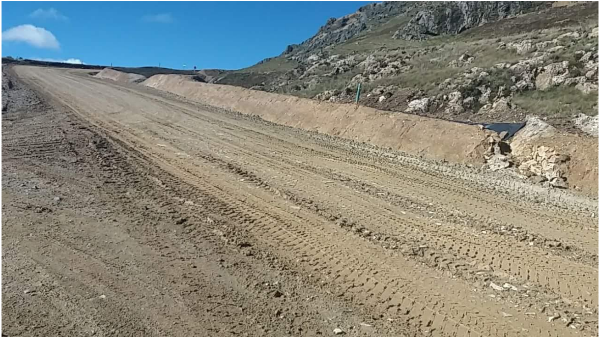
Vías en mal estado
