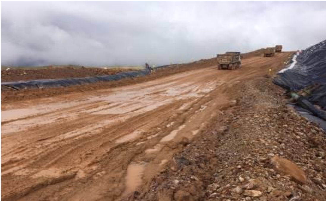
Vías en mal estado
