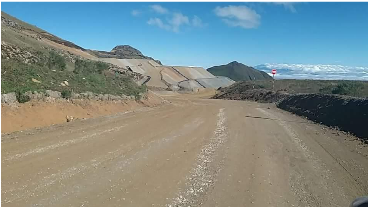
Vías en mal estado
