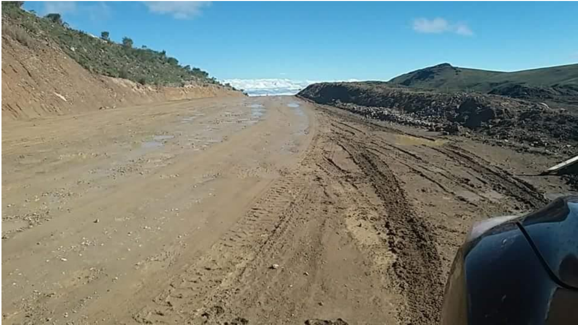
Vías en Mal estado
