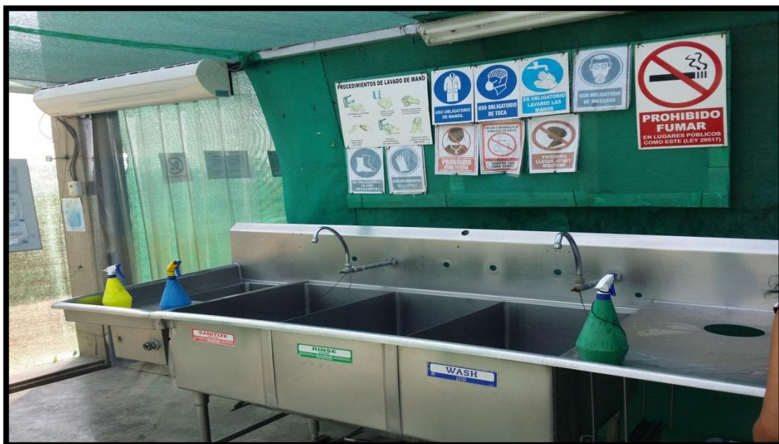
Imagen 03. Área de esterilización de la planta de operaciones - Huaral
