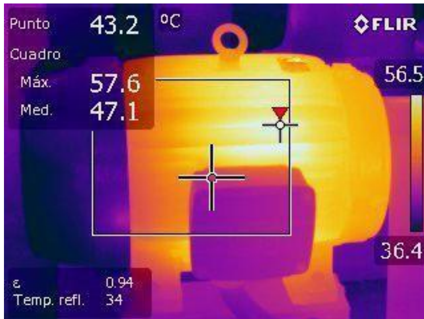
Figura n.º 40. Termografía aplicado a motores eléctricos
