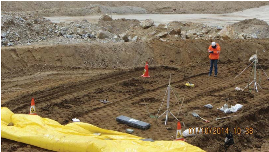
Foto 17: Vista panorámica de ejecución del ensayo de permeabilidad con Guelph, densidades con cono de arena y densímetro nuclear en el Panel Test N° 1 - Fecha 01-10-14.
