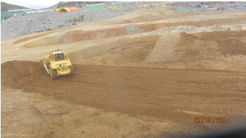
Foto 6: Habilitación del área de trabajo (Fundación/Piso) para la ejecución de Panel Test - Fecha 29-09-14.
