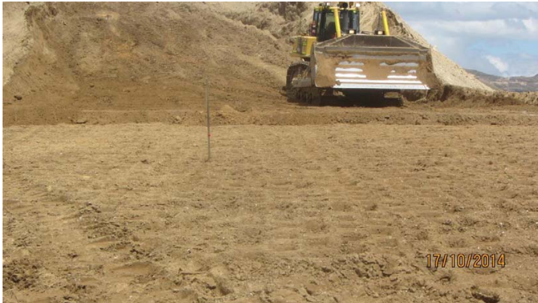
Foto 3: Habilitación de área de trabajo para confinamiento de material usado en Panel Test N° 2 - Fecha 17-10-14.
