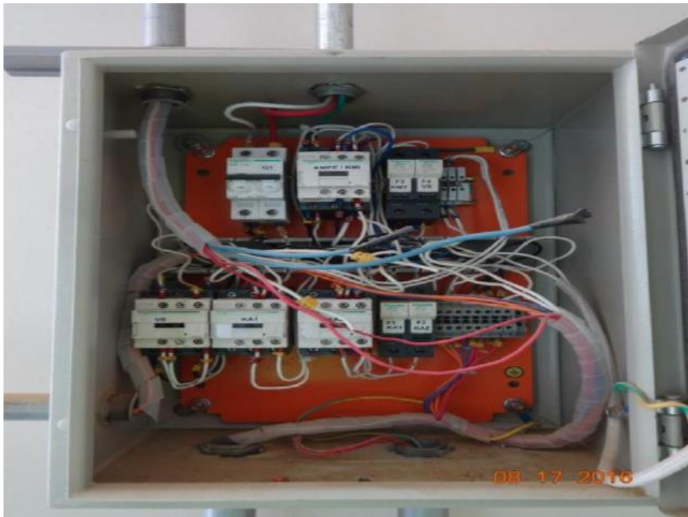
Figura n.º III-23 Tablero en grupos electrógenos Fuente: Informes de mantenimiento de DAT Ingeniería SAC
