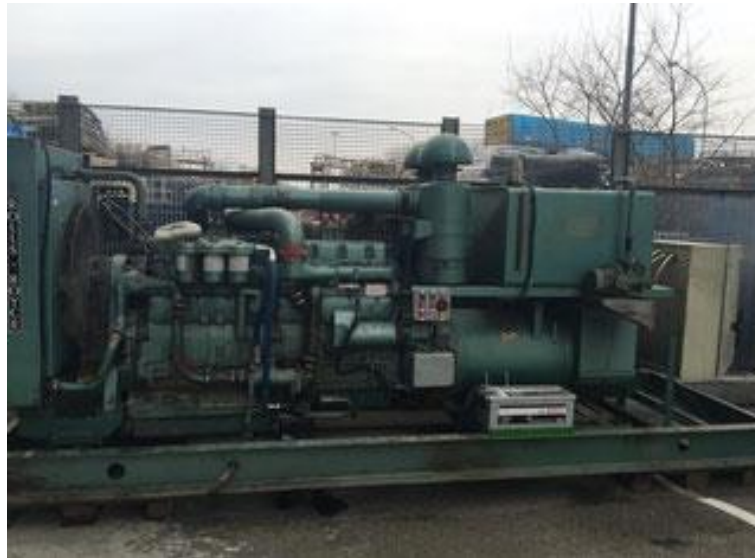
Figura n.º III-34 Grupo electrógeno Rolls Royce Fuente: Sitio Web Exapro
