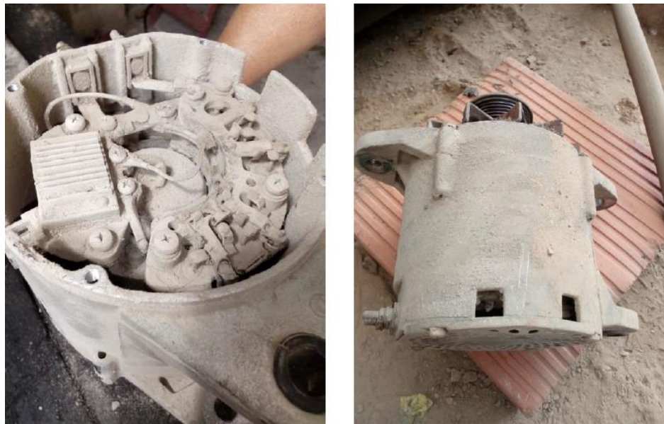
Figura n.º III-6 Imágenes de un alternador sucio retirado de un grupo electrógeno Fuente: Informes de mantenimiento de DAT Ingeniería SAC
