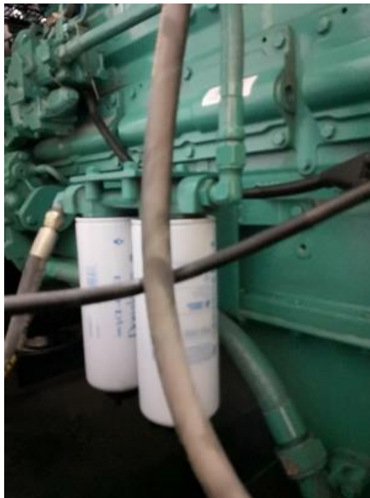
Figura n.º III-5 Sistema de combustible. Filtros Fuente: Informes de mantenimiento de DAT Ingeniería SAC
