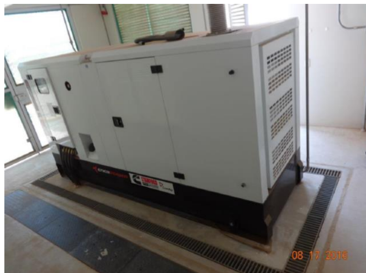
Figura n.º III-28 Grupo electrógeno Enerpower
