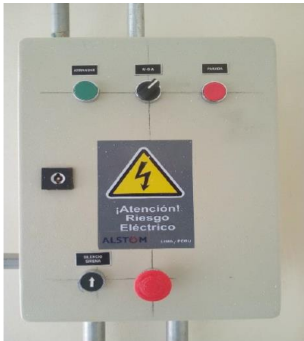
Figura n.º III-25 Tablero eléctrico. Tapa exterior Fuente: Informes de mantenimiento de DAT Ingeniería SAC
