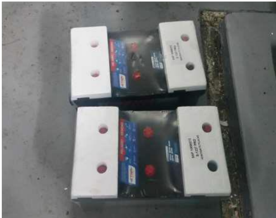
Figura n.º III-15 Baterías empleadas en grupos electrógenos Fuente: Informes de mantenimiento de DAT Ingeniería SAC
