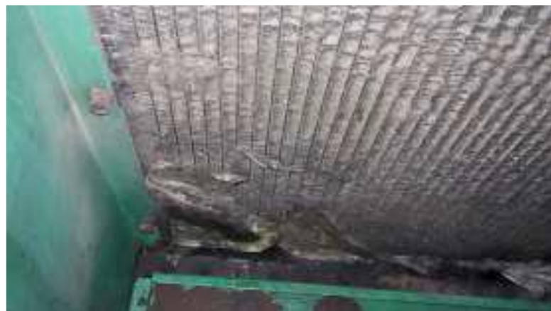
Figura n.º III-9 Radiador con falla Fuente: Informes de mantenimiento de DAT Ingeniería SAC
