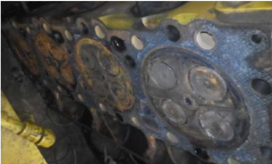
Figura n.º III-2 Culata de motor deteriorada en grupo electrógeno Fuente: Informes de mantenimiento de DAT Ingeniería SAC
