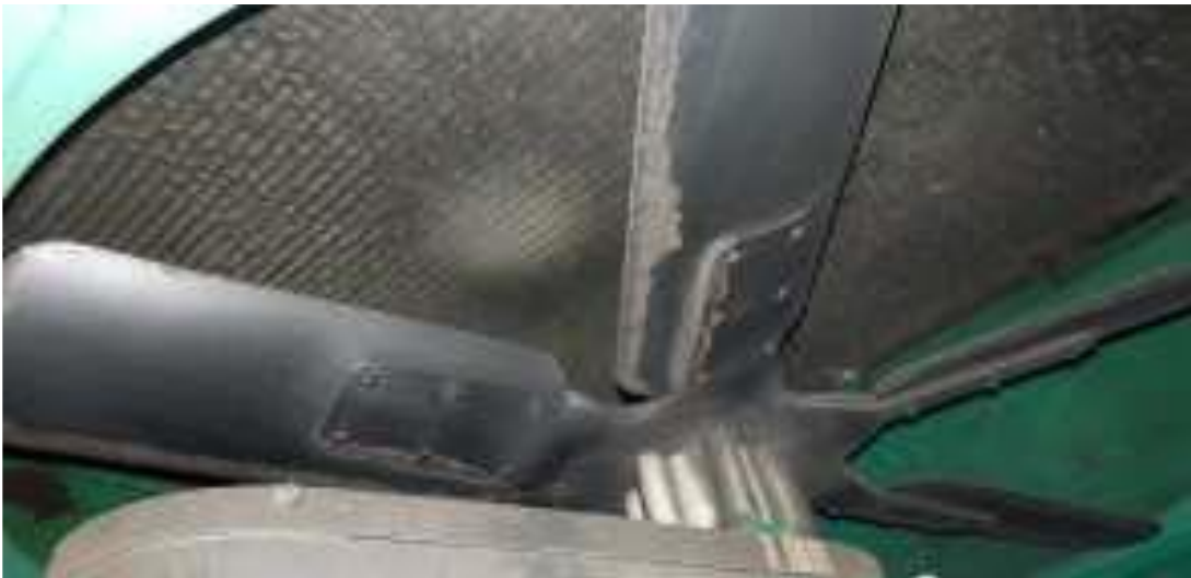
Figura n.º III-10 Radiador con inicio de deformación Fuente: Informes de mantenimiento de DAT Ingeniería SAC
