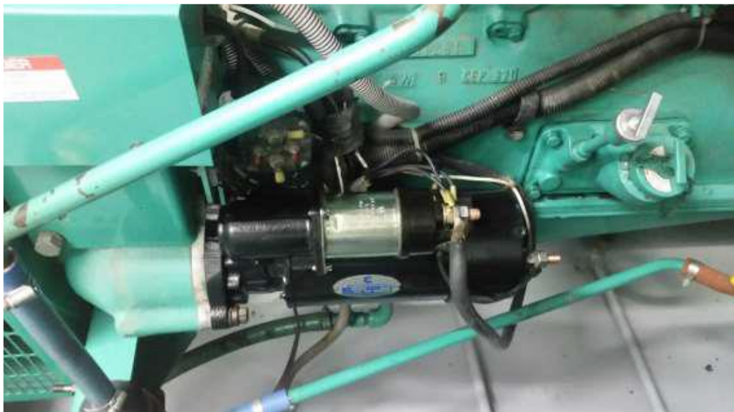
Figura n.º III-14 Arrancador colocado en su posición dentro del motor Fuente: Informes de mantenimiento de DAT Ingeniería SAC
