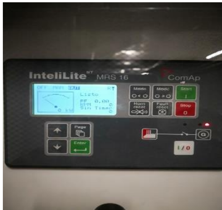
Figura n.º III-3 Tablero de control digital Fuente: Informes de mantenimiento de DAT Ingeniería SAC
