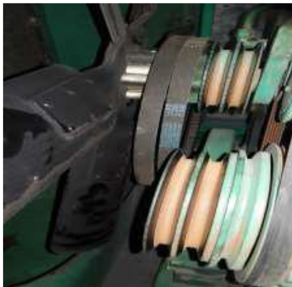
Figura n.º III-26 Sistema de poleas con rodamientos Fuente: Informes de mantenimiento de DAT Ingeniería SAC
