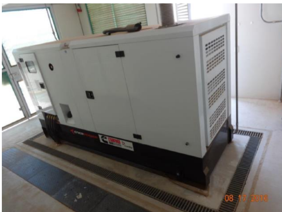
Figura n.º III-1 Grupo electrógeno típico en instalación del cliente Fuente: Archivo de fotografías de la empresa
