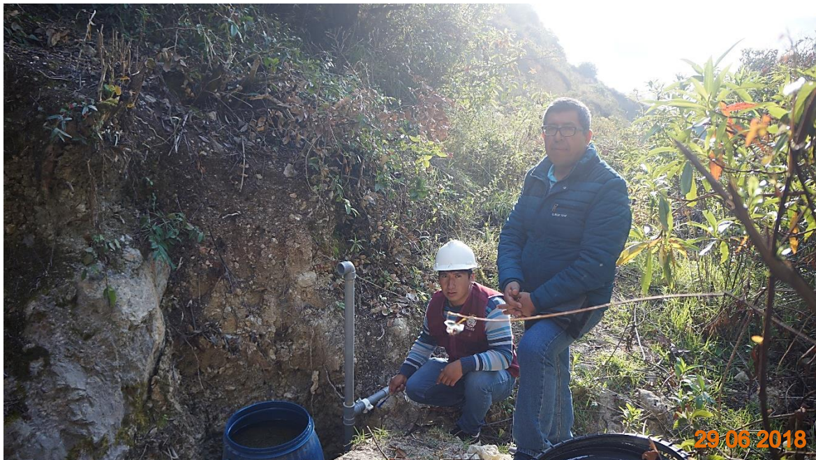
Figura 78. Inspección de filtro de la captación 2 por parte del Dr. Ingeniero Orlando Aguilar
