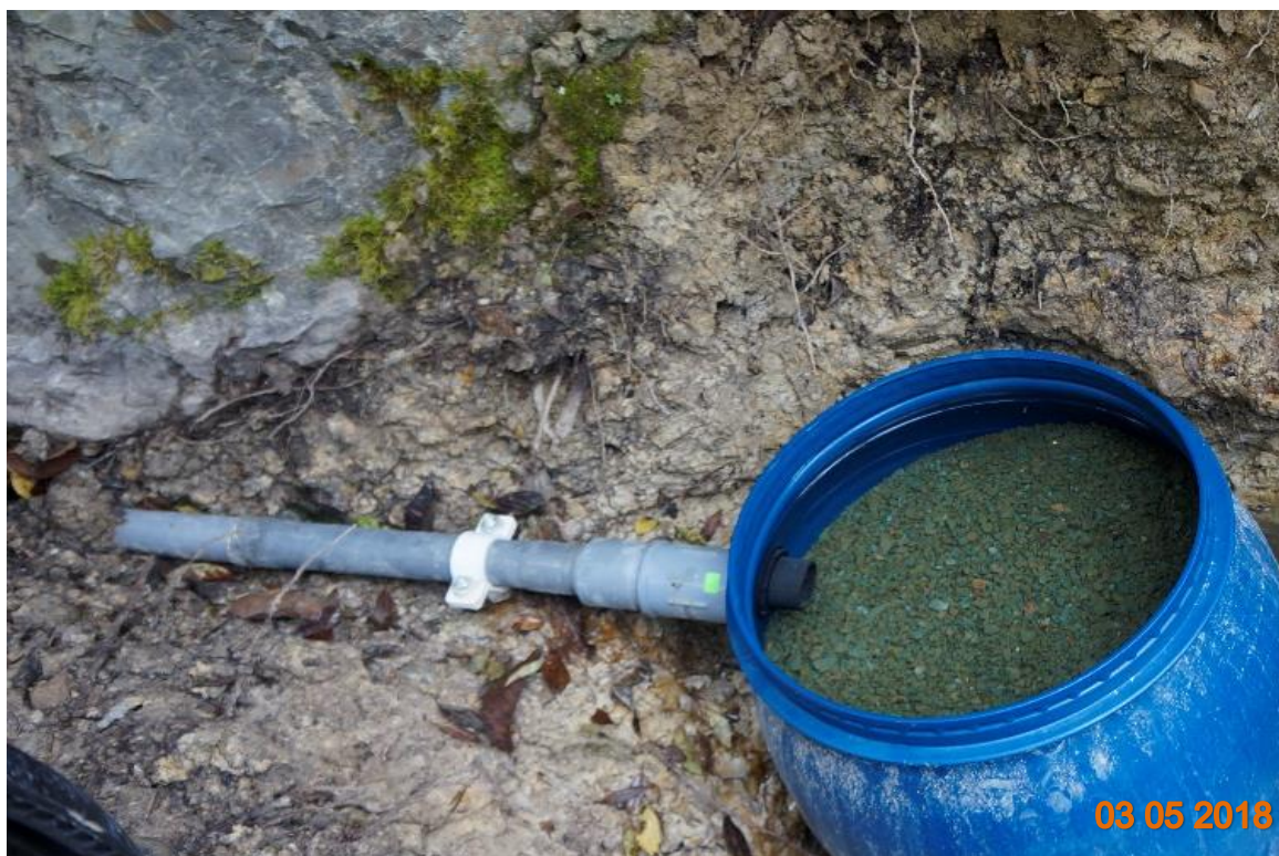
Figura 65. Funcionamiento del filtro - Captación 2.
