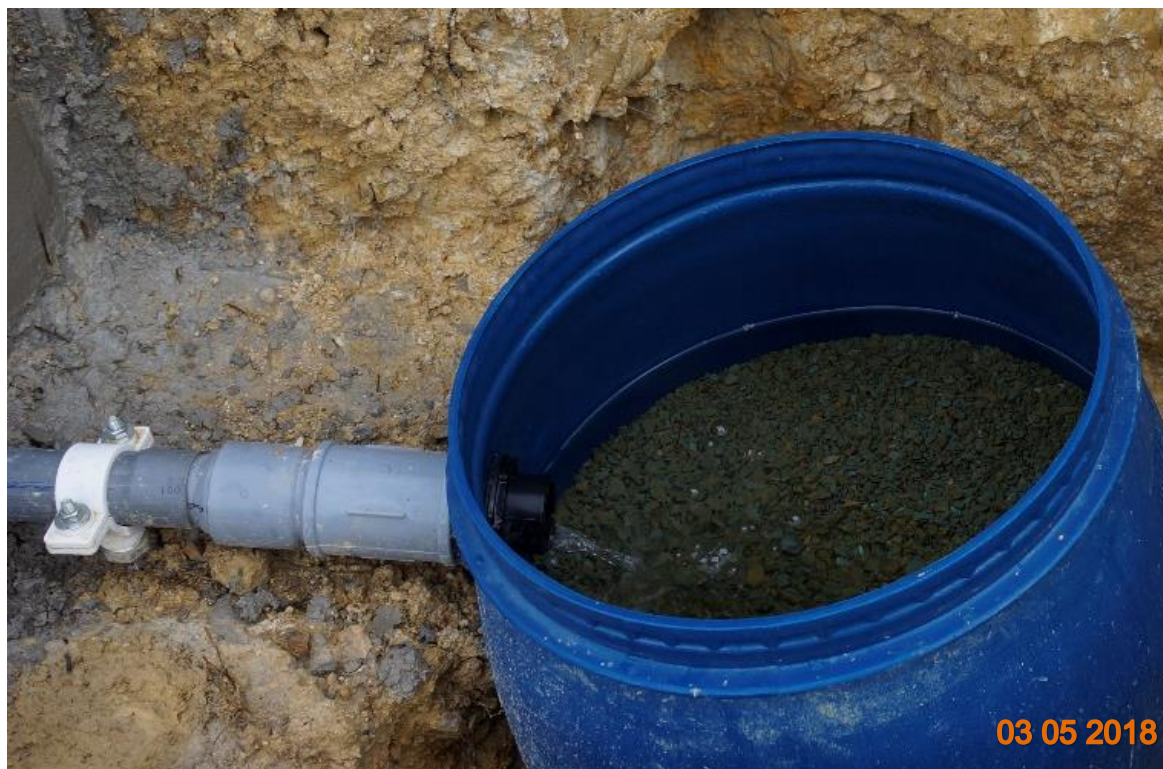
Figura 64. Funcionamiento del filtro - Captación 1.
