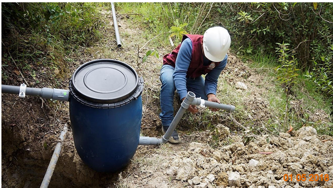
Figura 58. Accesorios instalados en los tanques.
