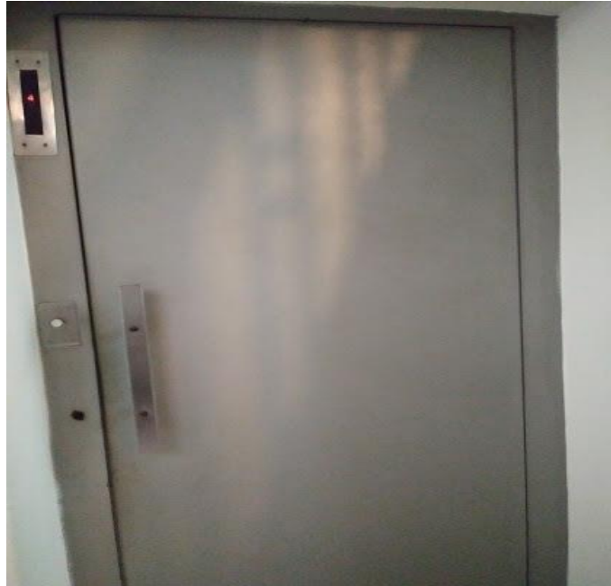
Fotografía N° 21: Ascensor del Hotel Saint Germain
