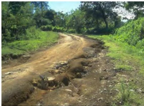
Figura n°. 7: Drenaje inadecuado
