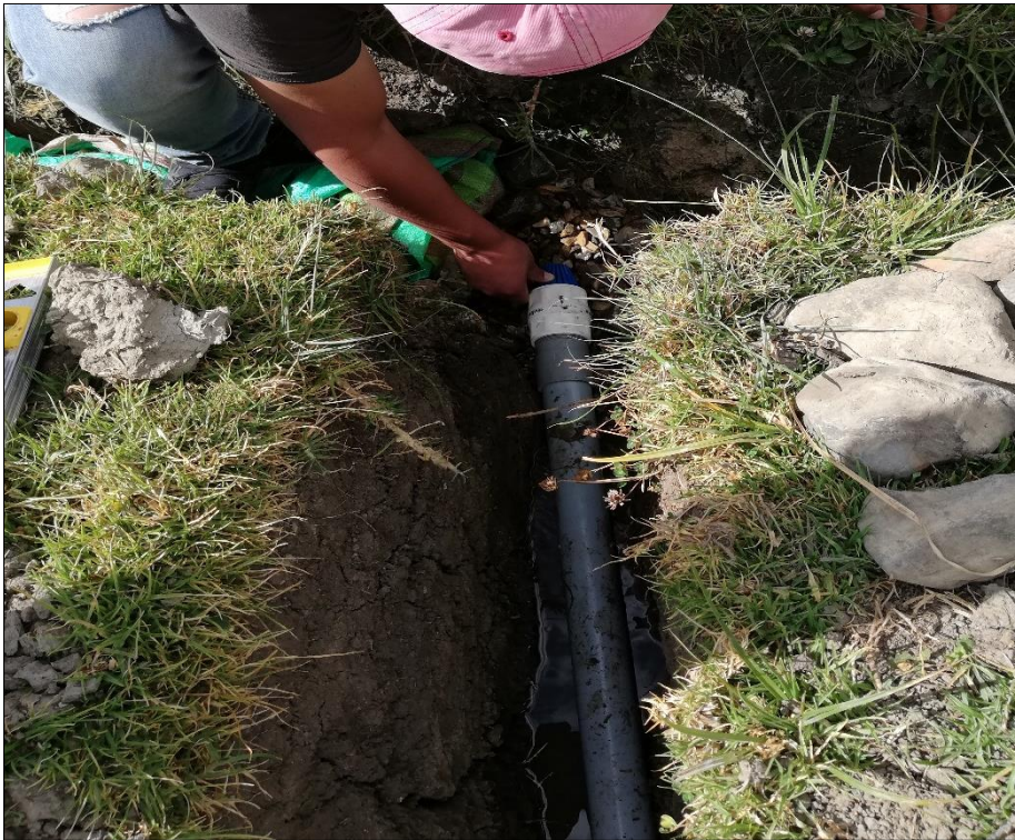
Fotografía N° 8: Colocación de canastilla a tubería de alimentación para filtro de carbón activado
