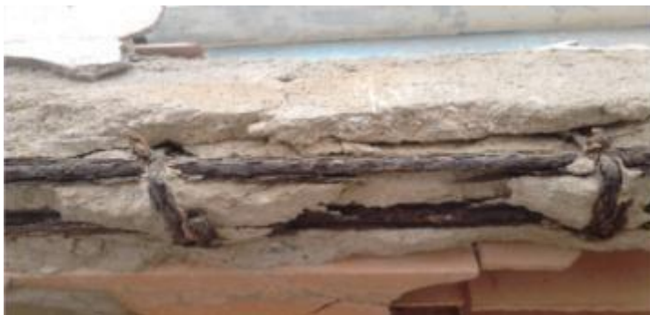
Figura n° 6. Barras corrugado de acero expuesto, producto de la carbonatación.
