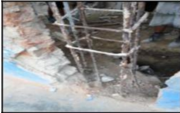
Figura n.º 10. Armadura con corrosión evidente.
