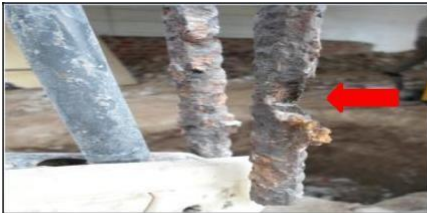
Figura n.º 11. Barra corrugada de acero en columna con signo de corrosión.
