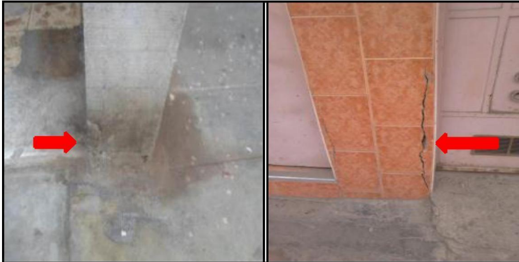
Figura n.º 12. Columnas con fisura en su base
