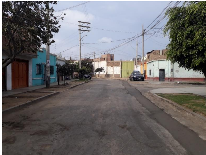
Figura 77: Inspección visual de Calle Tacna.
