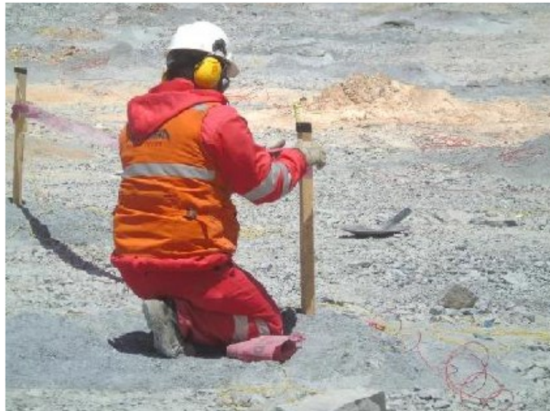
Foto3 Colocado de cachaco y cinta de peligro en taladro
