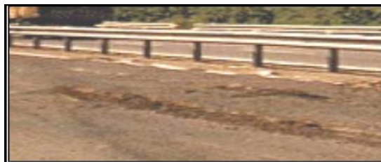
Figura 10: Desenvuelta en los pavimentos asfálticos.
