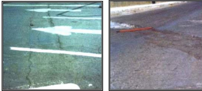
Figura 7: Fallos en la construcción de pavimentos asfáltico.
