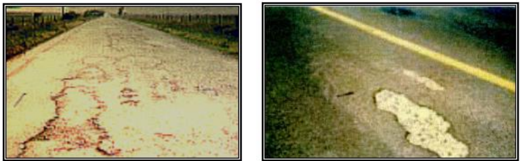
Figura 9: Segregación en pavimentos asfálticos.
