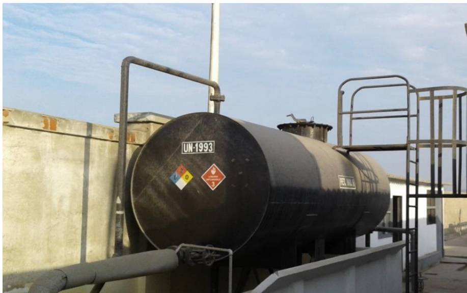
Figura N° 24 Topología actual de tanque de almacenamiento de hidrocarburo líquido PI-6
