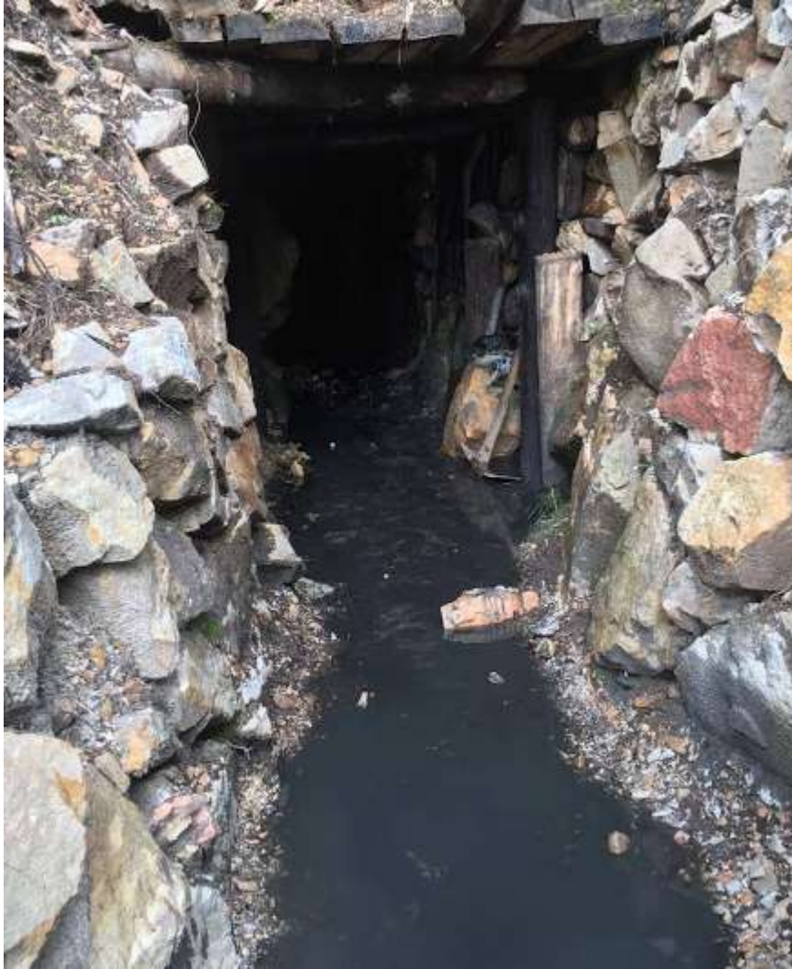
Figura 6. Presencia de agua en las labores
