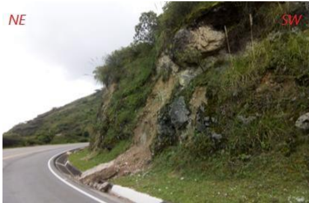
Figura 30. Evidencia de deslizamiento antes del llevar al talud 139 + 450 al 139 + 500.
