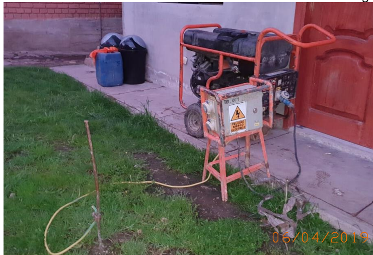
Fotografía 17 Generador y tablero eléctrico.
