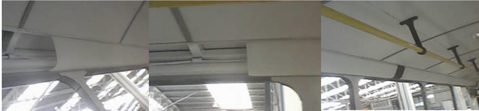
Figura 21: Imágenes tomadas de luminarias del salón
