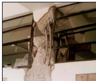
Figura 10. Efecto de columna corta. Fuente: Blanco, 2010.
