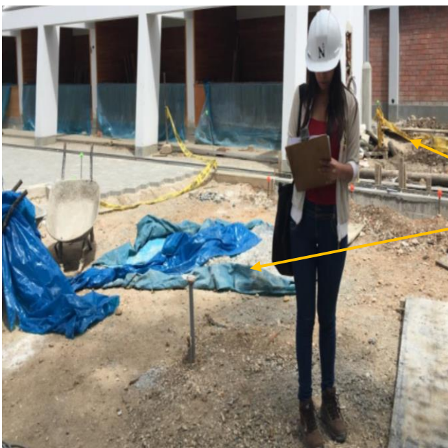
Figura 33: Área de trabajo desordenada
