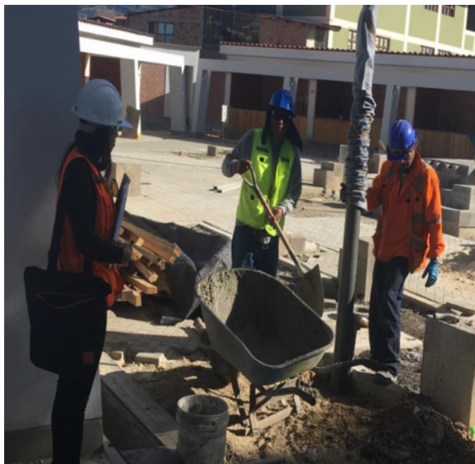
Figura 35: Falta de vigía
