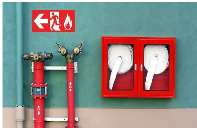
Figura 14: Prevención de Incendio
