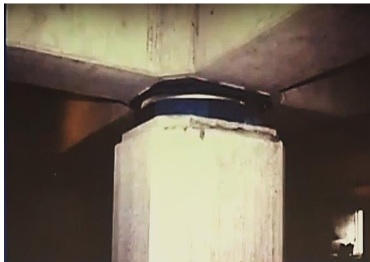
Figura 16: Instalación de FPT en la parte superior de la columna. No hay necesidad de piso técnico para los aisladores.
