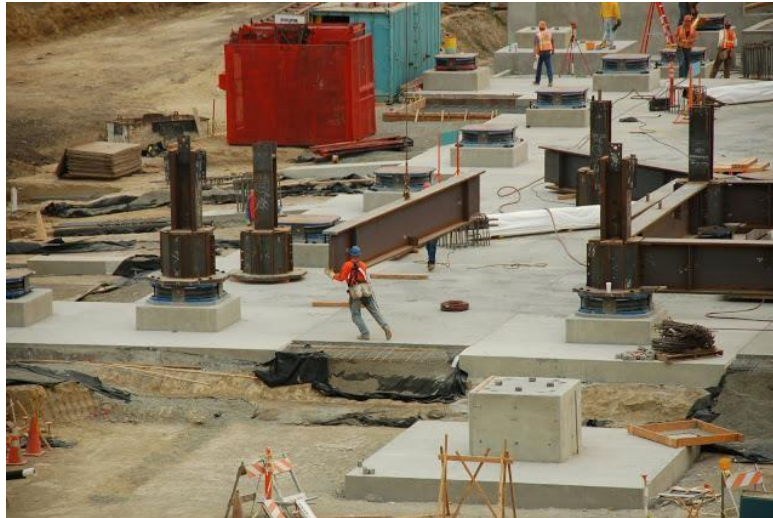
Figura 17: interfaz de aislación ubicado entre la cimentación y la losa del primer piso.
