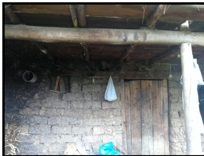
Arriostre horizontal inexistente.
