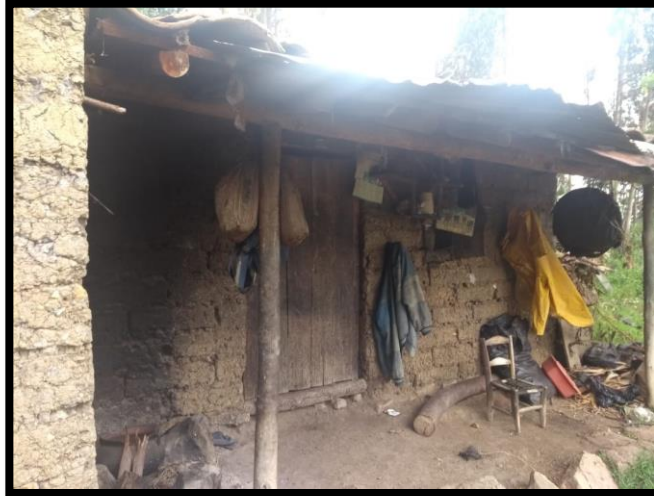
Alero inadecuadamente anclado
