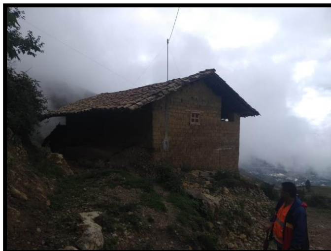
Ausencia de refuerzos horizontales
