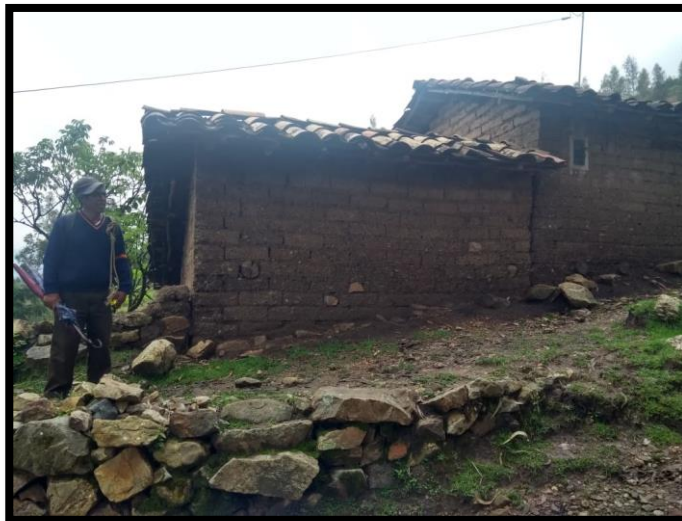
Ausencia de veredas perimetrales
