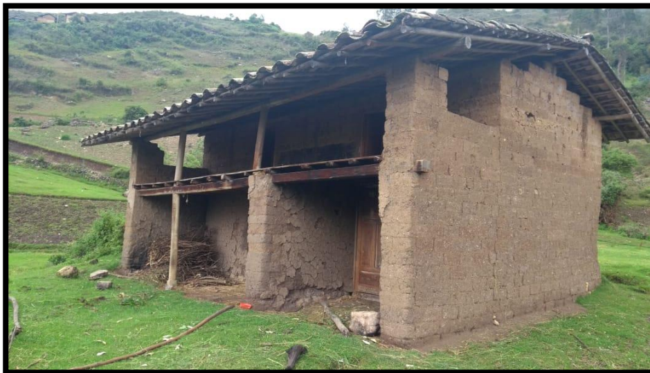
Vivienda que incumple la norma: ausencia de arriostres horizontales, vanos y contrafuertes inadecuados.
