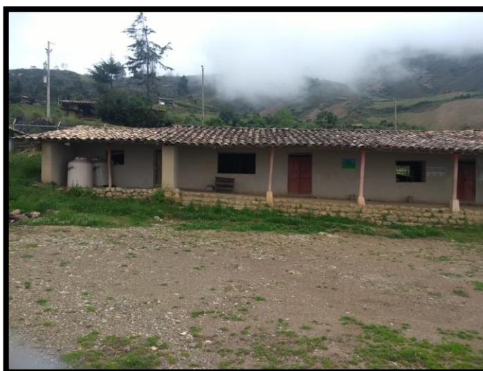
Patio de la escuela con ausencia de sistema de drenaje.
