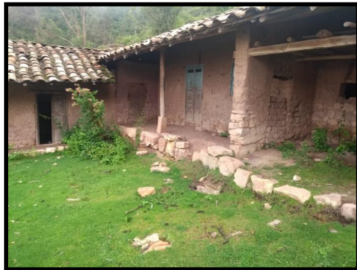
Vanos con proporciones y ubicaciones inadecuados.
