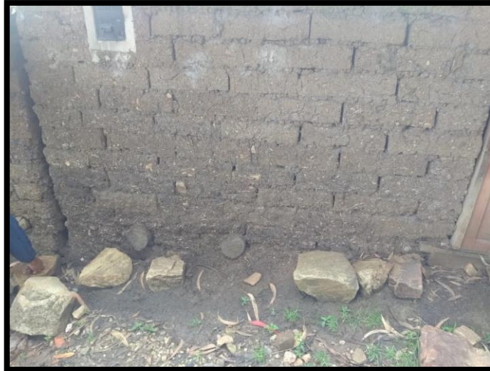
Ausencia total de cimentacion y juntas verticales sin mortero.
