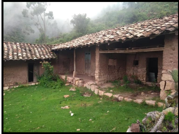
Vivienda con patio interior con inadecuado sistema de evacuación y evaporación del agua de lluvias.
