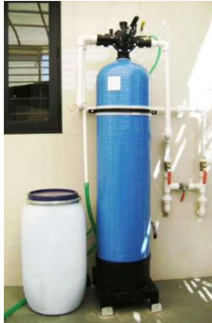
Figura 21. Tanque de carbón activado.
