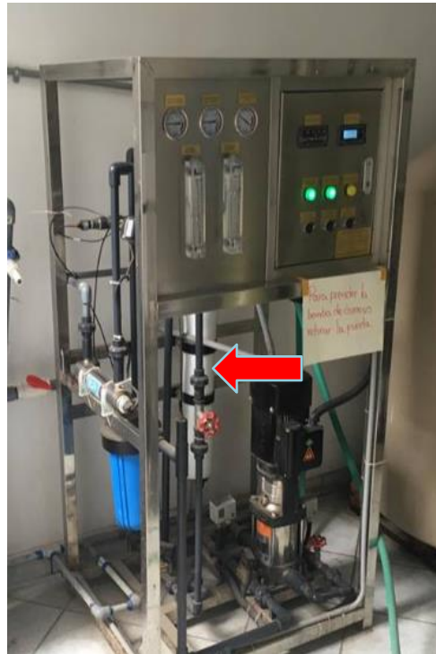
Figura 23. Membrana de osmosis inversa. Fuente: Empresa Tecnología de Membranas.
