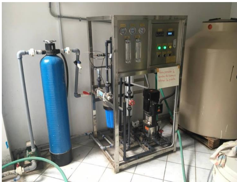
Figura 20. Planta de osmosis inversa.
