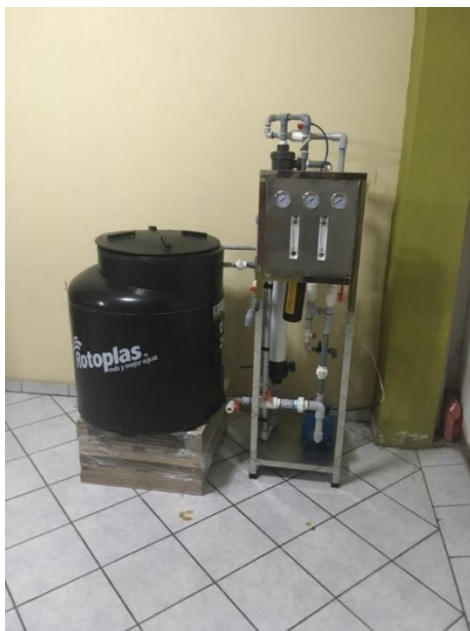
Figura 1. Módulo de ultrafiltración.
