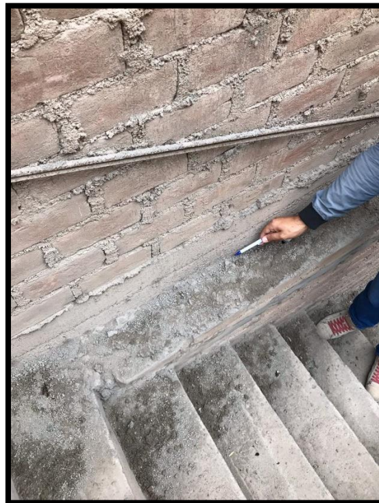
Figura 57: Sin junta sísmica
