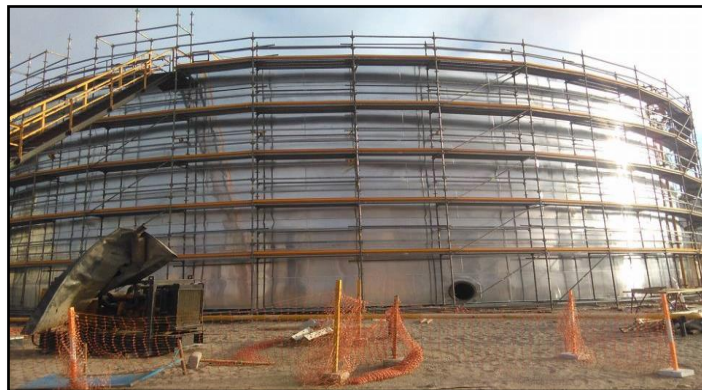
Figura 7. Aislamiento térmico con lana mineral y planchas de aluminio
