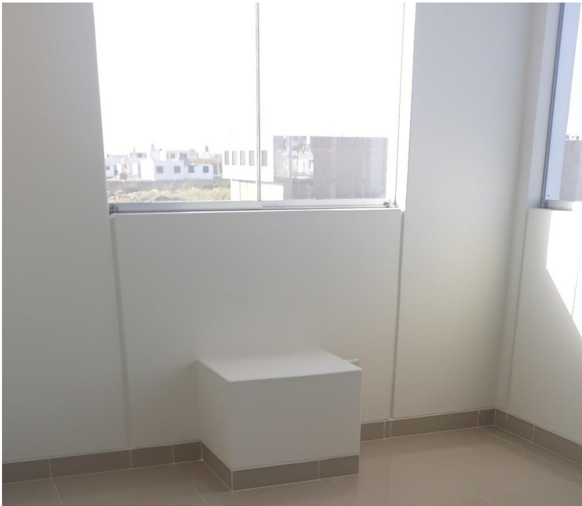
Ilustración 21. Ducto de aire acondicionado como elemento arquitectónico.
