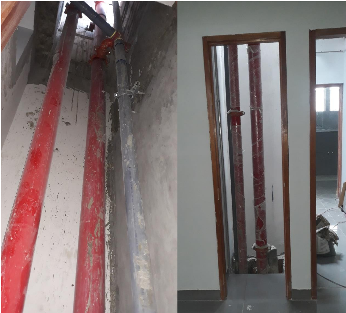
Ilustración 17. Instalaciones por ductos de servicio.
