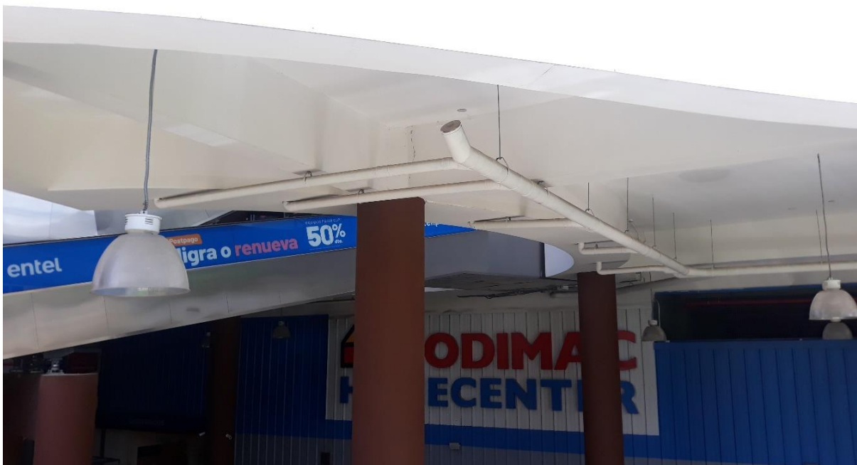
Ilustración 12. Tuberías colgantes con poco impacto visual.
