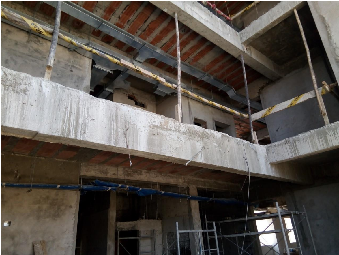
Ilustración 13. Bandejas metálicas para instalaciones.
