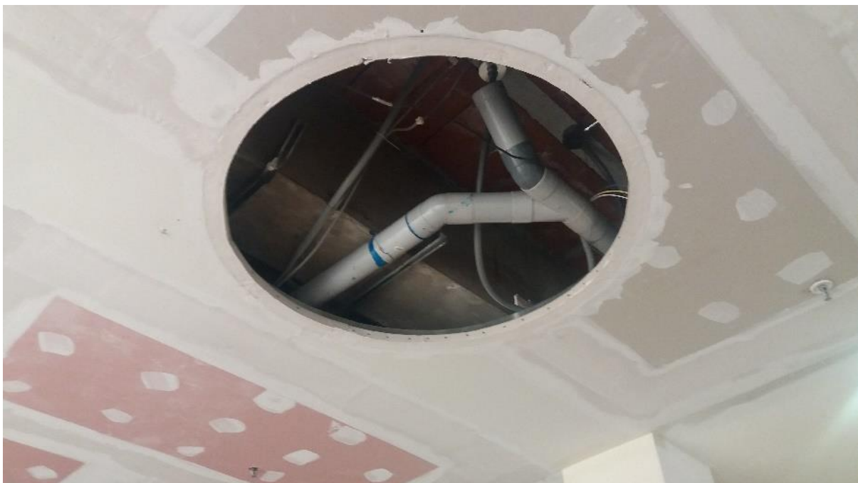
Ilustración 10. Tubería PVC 4'' colgante, debajo de una viga peraltada.
