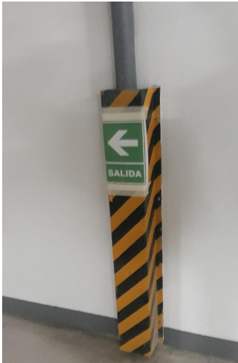
Ilustración 16. Falsa columna de metal, ocultando tubería PVC de 4”.
