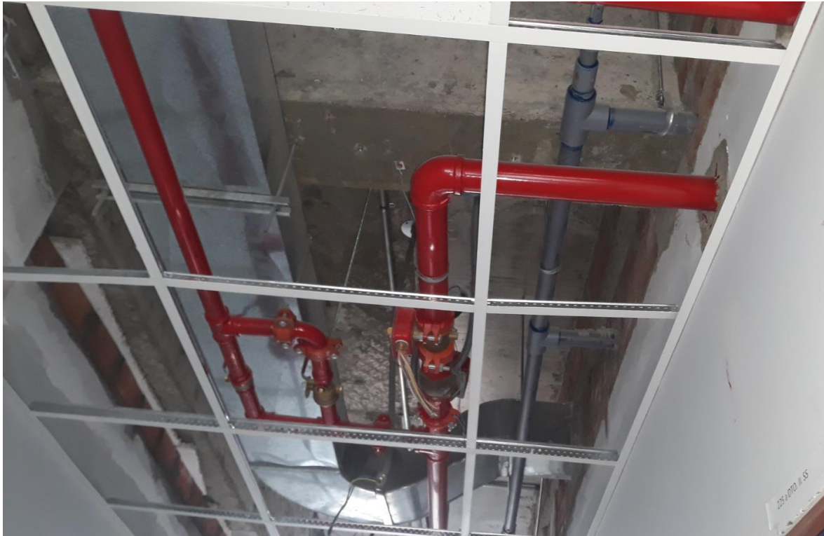
Ilustración 11. Diversas instalaciones colgantes.
