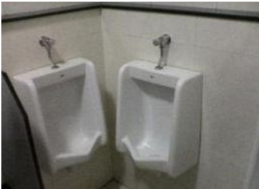
Ilustración 1: Incompatibilidad de aparatos sanitarios
