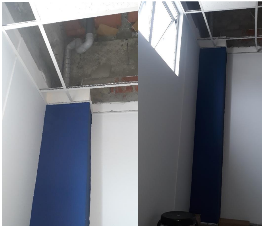
Ilustración 15. Falsa Columna de drywall
