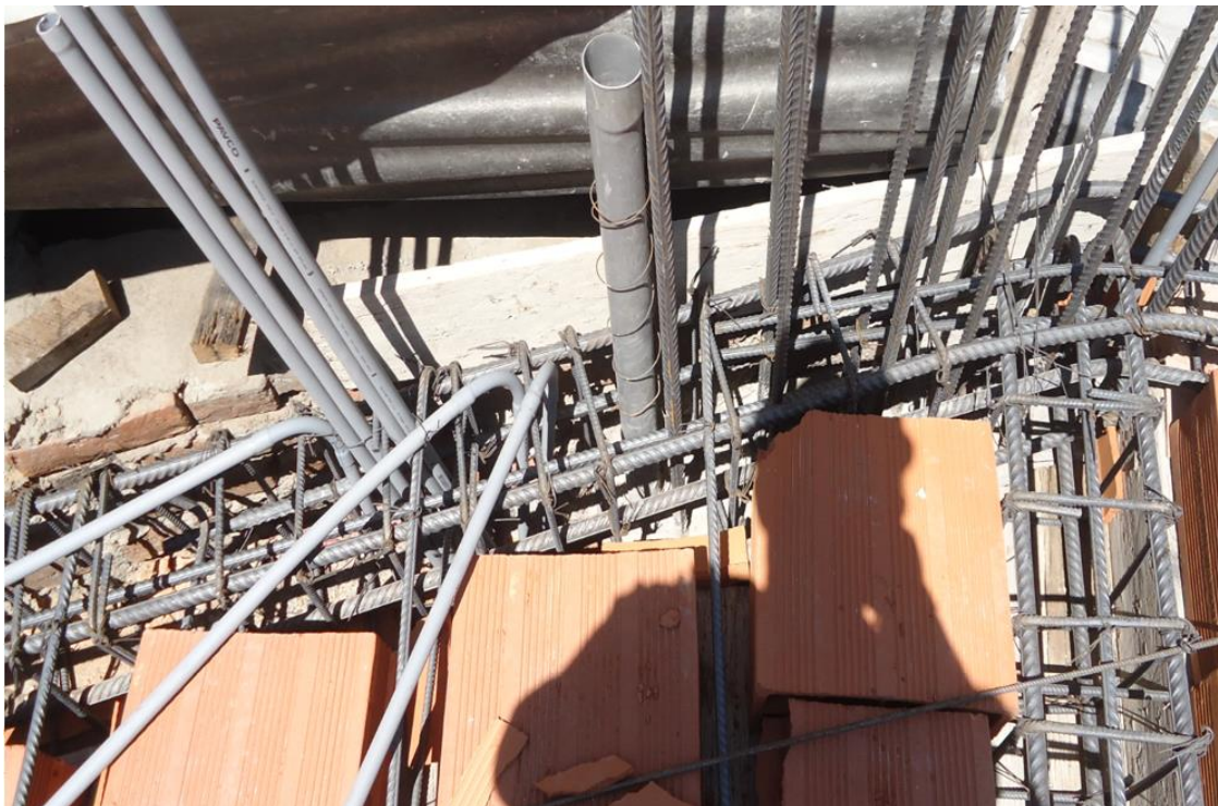
Ilustración 6: Tuberías de distintas especialidades atravesando elemento estructural.
