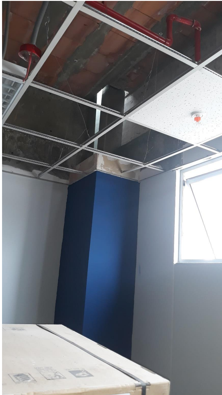
Ilustración 18. Ducto por donde pasan instalaciones mecánicas.
