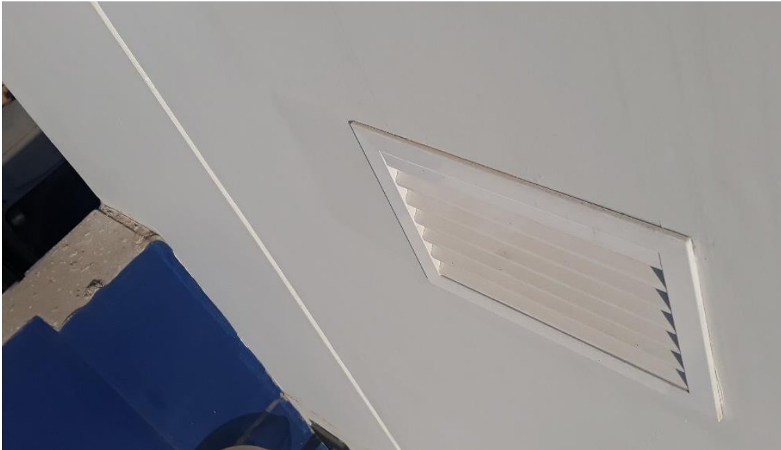
Ilustración 20. Rejilla de ducto, aire acondicionado
