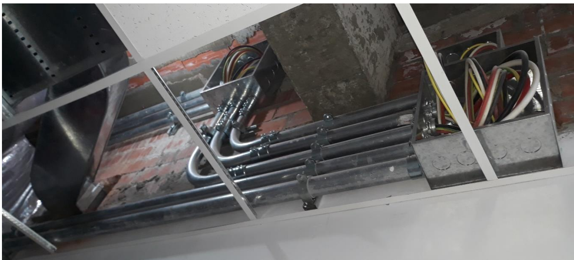
Ilustración 14. Instalaciones empotradas, sin impacto en elementos estructurales.
