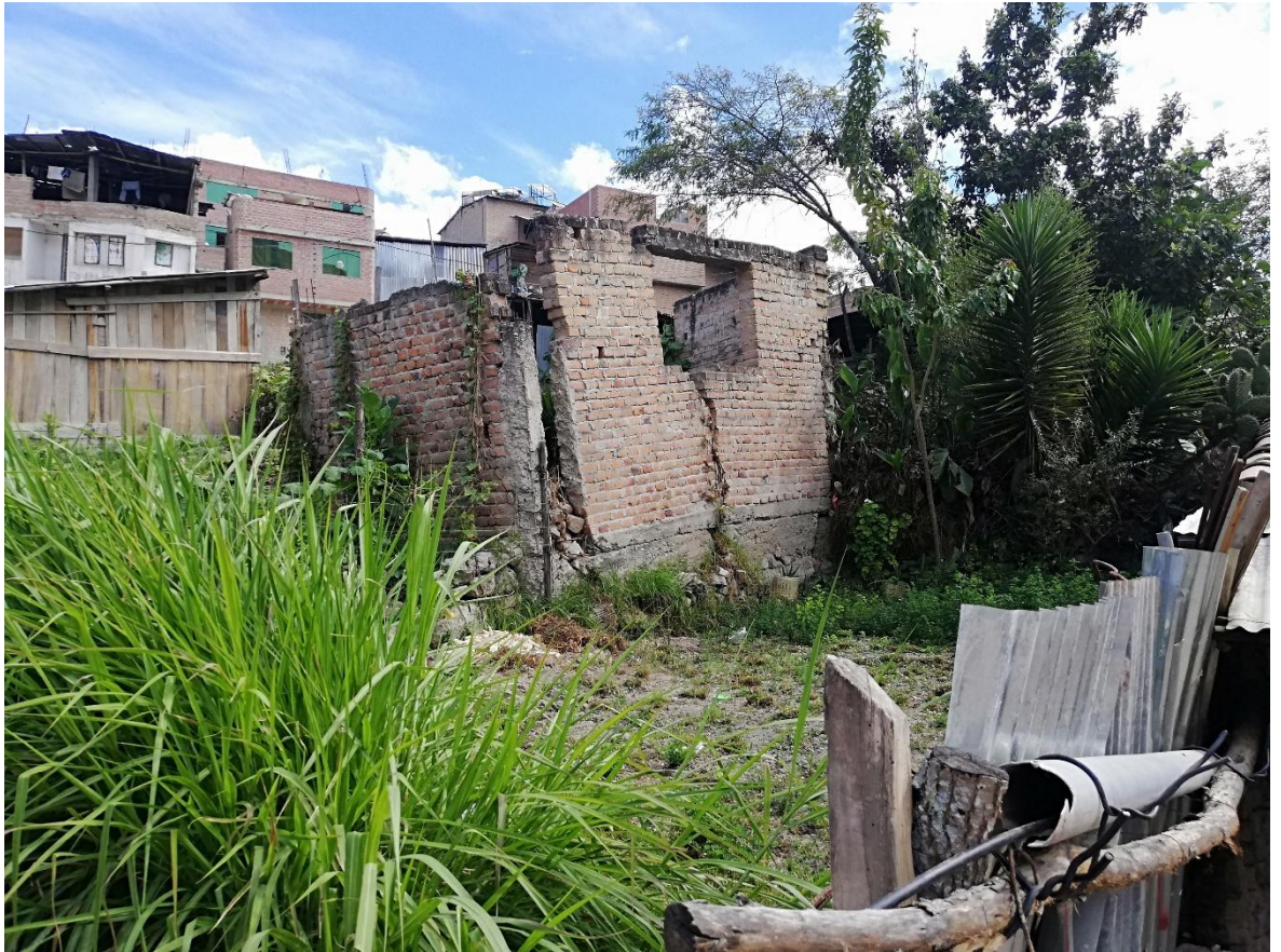
Figura 20: Estragos en las viviendas como consecuencia de los deslizamientos en el Barrio Cinco Esquinas - Bambamarca
