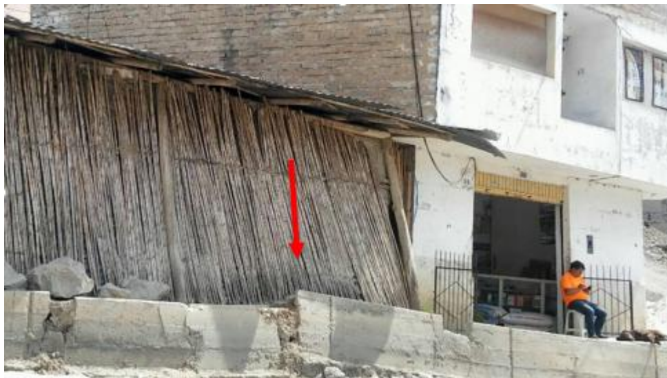
Figura 10: Rotura de una vereda ocasionado por la inestabilidad del suelo.
