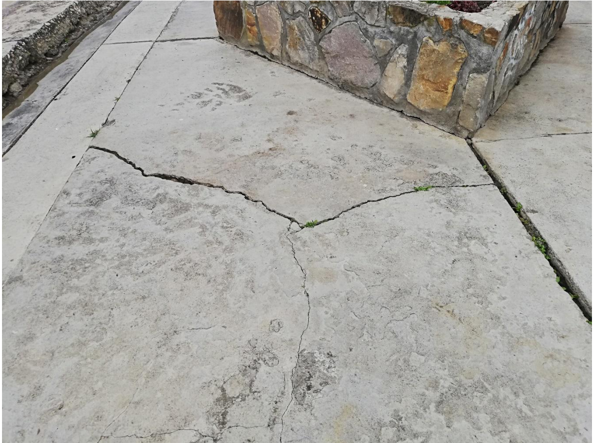
Figura 18: Rotura del pavimento en el jirón Bolívar - Bambamarca
