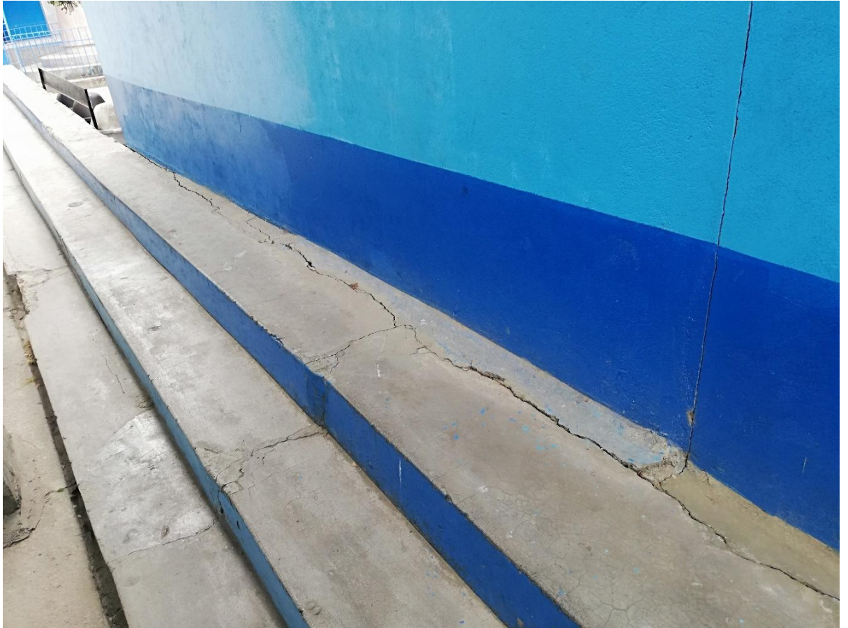
Figura 11: Daños en la infraestructura del colegio Nuestra Señora de Lourdes
