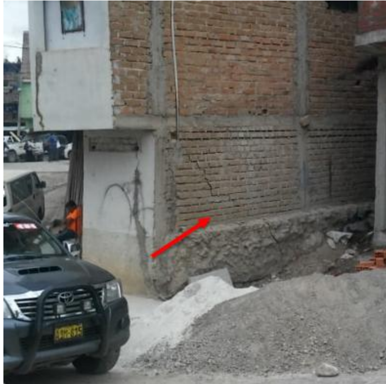
Figura 9: Fractura en la pared de una vivienda provocada por la aceleración del deslizamiento.
