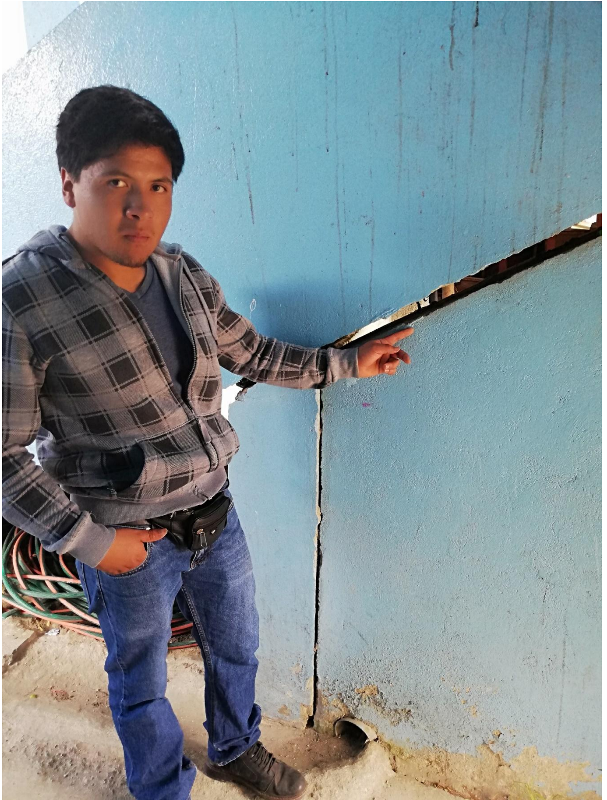
Figura 13: Daños en las gradas del colegio Nuestras Señora de Lourdes
