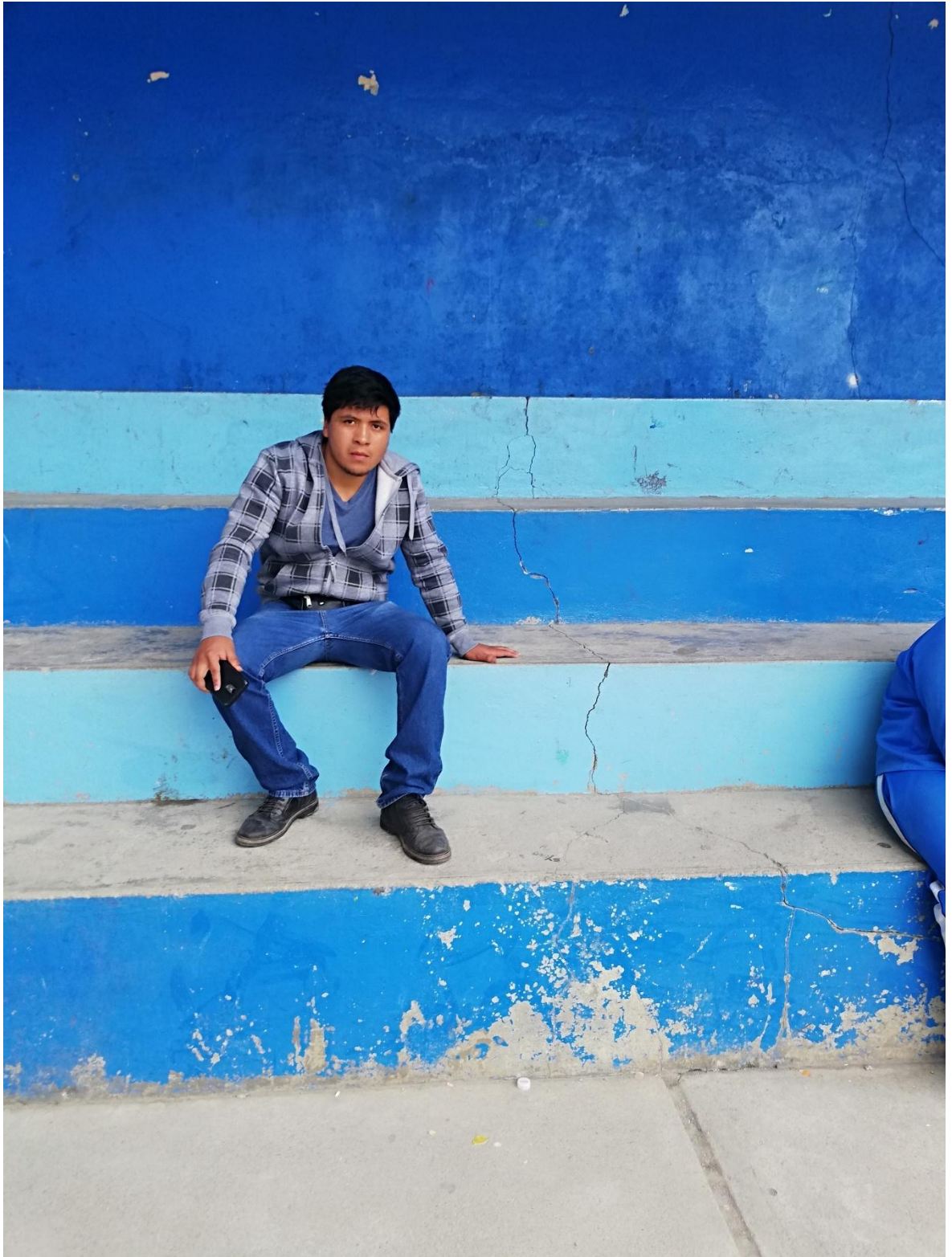
Figura 14: Rotura de gradas en el colegio Nuestra Señora de Lourdes.
