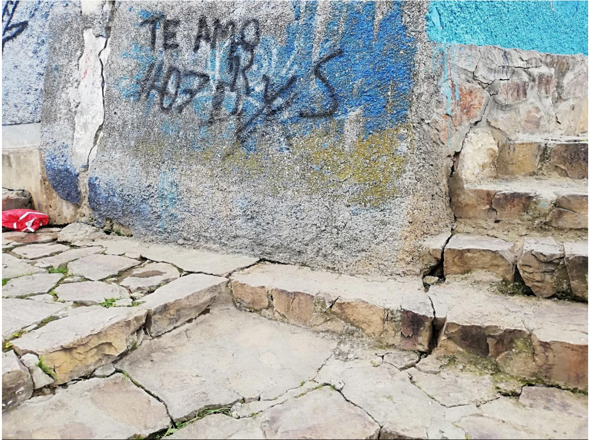
Figura 17: Rotura de veredas y vía pública entre los jirones Bolívar y Coronel Espinar de Bambamarca
