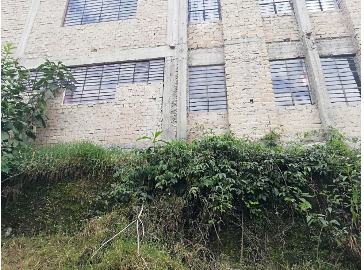
Figura 16: Rotura de paredes en el colegio Nuestra Señora de Lourdes
