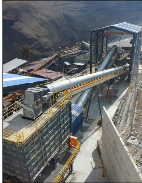
Figura N° 7: Planta de chancado nuevo
