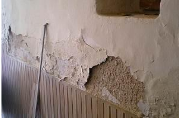
Fig. 5: Eflorescencia en muros. (Moyano, 2014).
