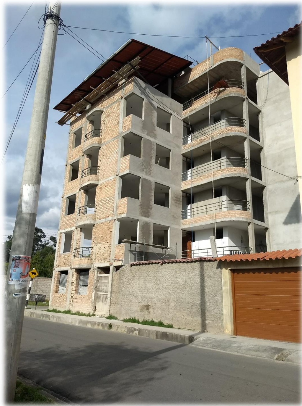
Figura 39: No cuenta con sistema de aire ventilados mecánicamente con control de entrada de contaminantes al aire del edificio.
