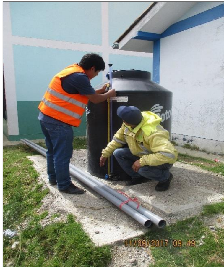
Figura 4: Medición en tanque de polietileno para los 1000 litros que se requiere bombear.
