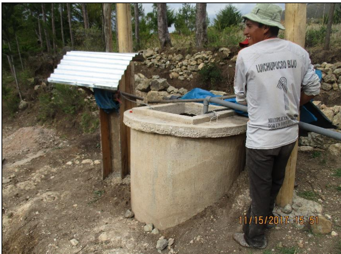
Figura 10: Pozo subterráneo 02 (Exterior), de propiedad del Sr. Natividad Portal Ramírez.
