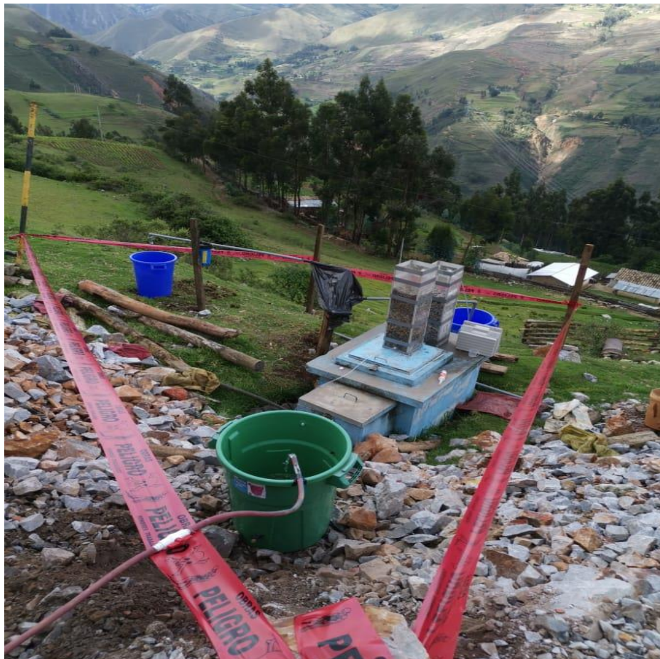
Figura 25: Sistema piloto armado.
